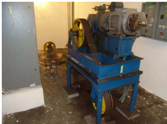
Společná strojovna pro dva výtahy
