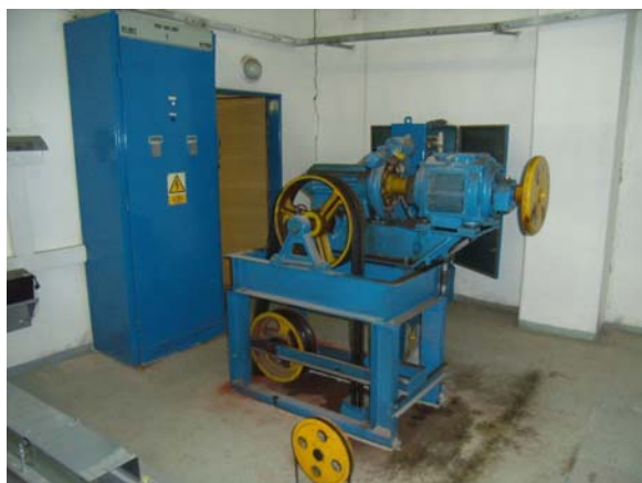
Společná strojovna pro dva výtahy
