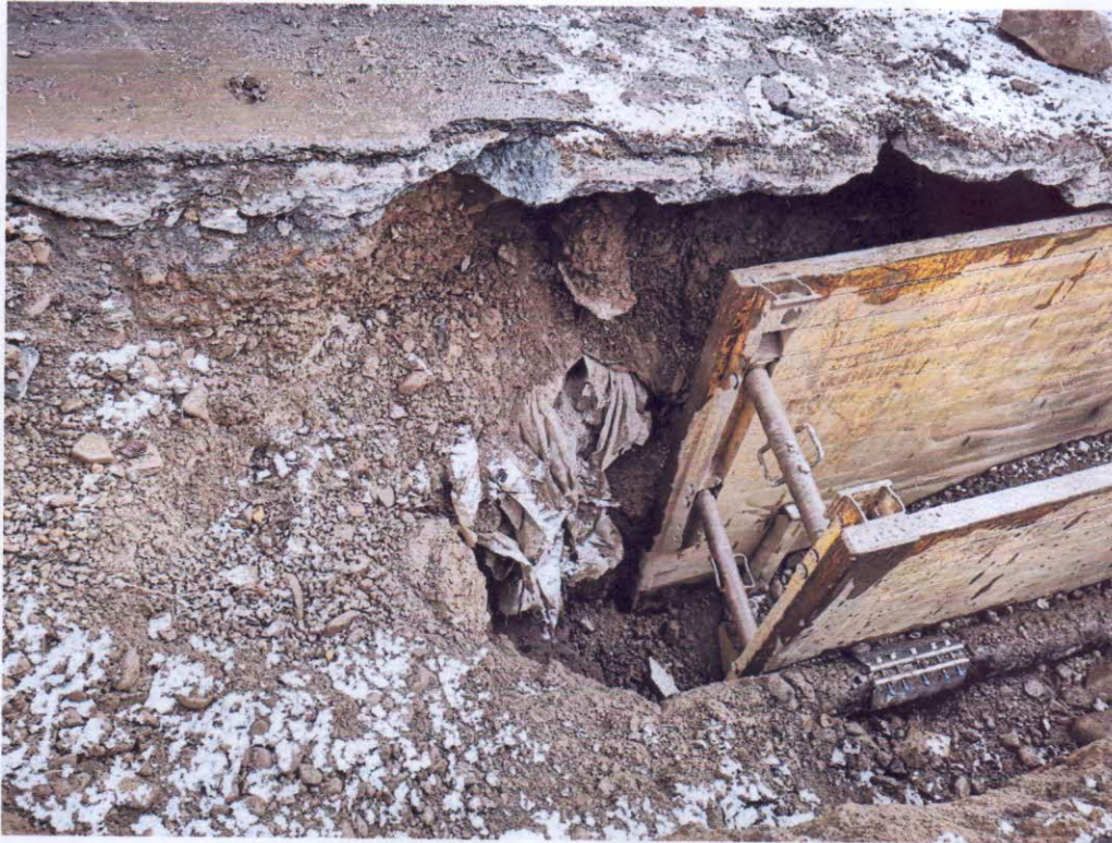
Další zdroj problémů vypadávání zeminy – odpad, po kterém materiál sklouzává
