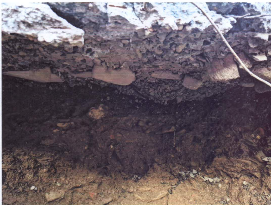
Spodní pohled na betonovou vrstvu a stěnu původního zkonsolidovaného zásypu
