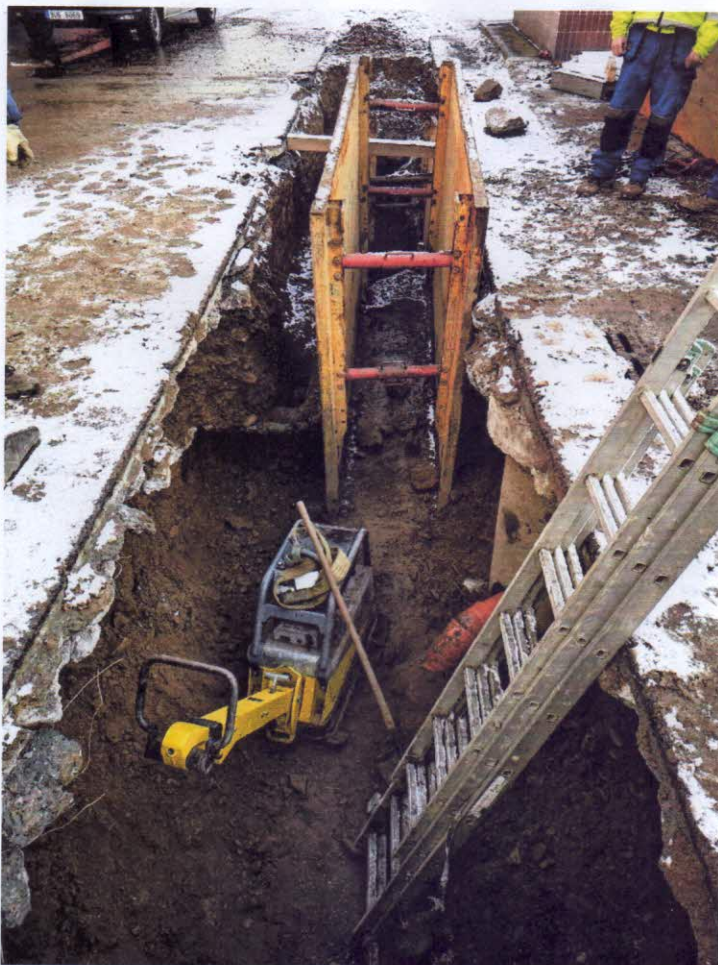
Pohled na trasu výkopu – vlevo zasahuje vypadávání zeminy až 1m pod vozovku, vpravo až 0,75m...
