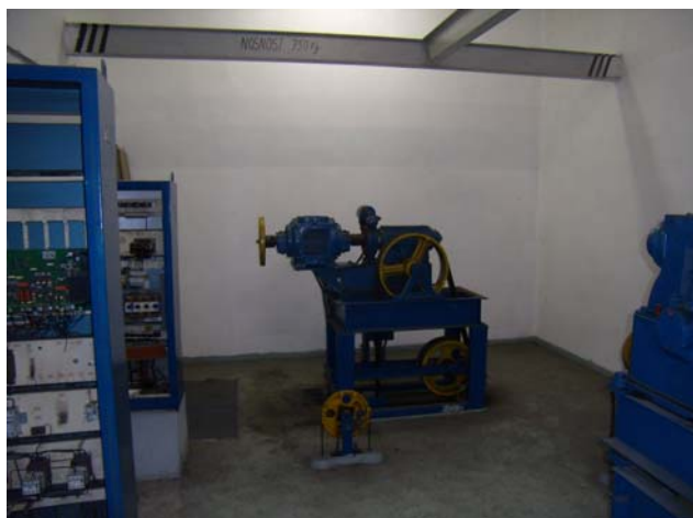
Strojovna výtahu – stroj SB 411 na ocelovém roštu s kladkou
