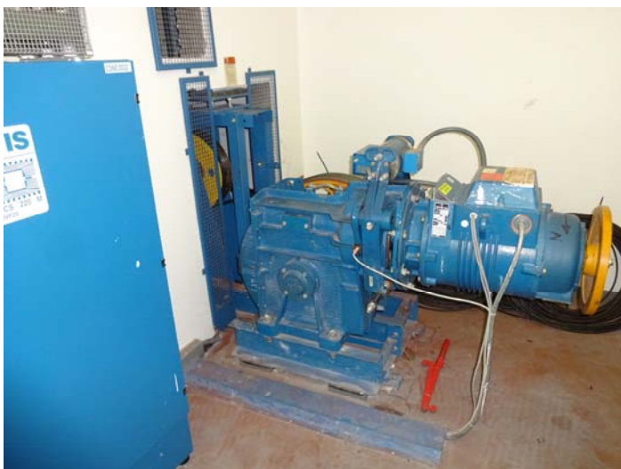
původní převodový stroj ve strojovně
