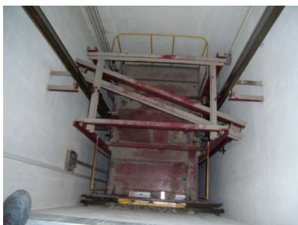
Pohled na vrchní zavěšení kabiny
