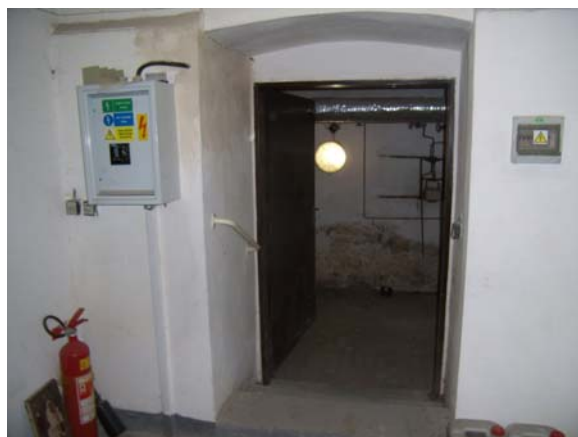
strojovna – vstup, hlavní vypínač
