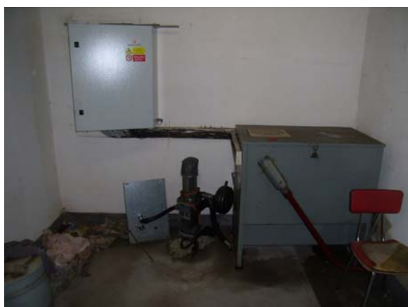
Strojovna v suterenu – čerpadlo, rozvaděč
