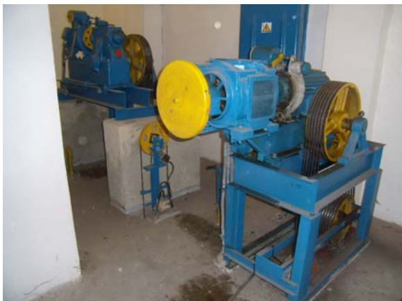
Strojovna výtahu – vzadu stroj výtahu č.11
