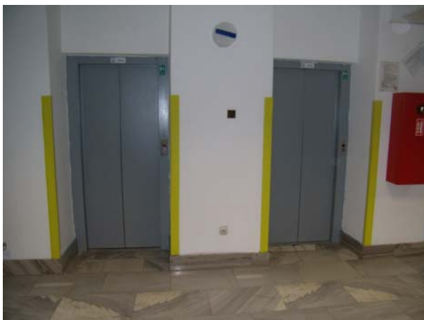
Nástupiště výtahu č.3 a 4
