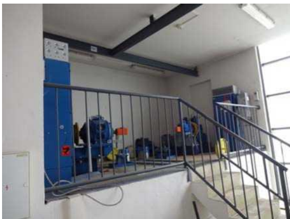
Strojovna výtahu - výtah č.1 je vpravo
