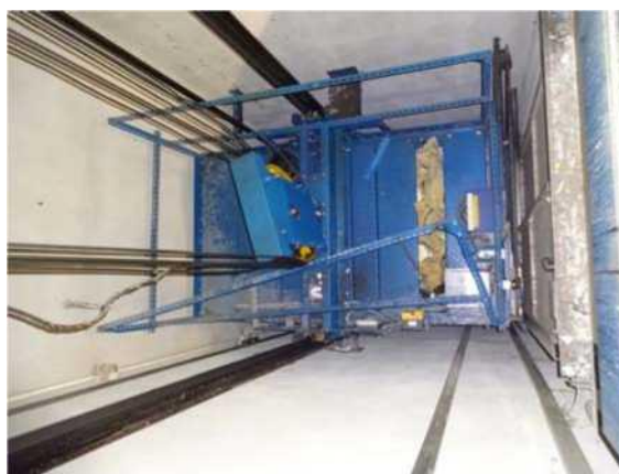
střecha kabiny a prasklé nosné lano
