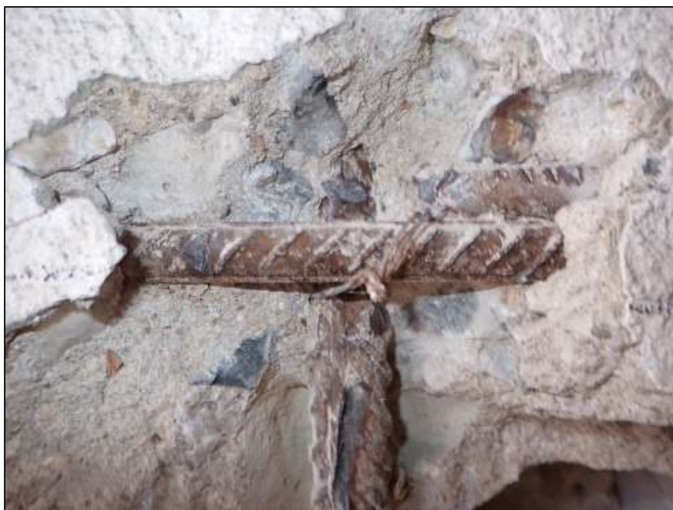
Foto 22: Detail sondy S2, monolitická část – pilíř, poloha viz Příloha 1. Svislá a vodorovná výztuž. Povrchová koroze (P) bez oslabení plochy průřezu.
