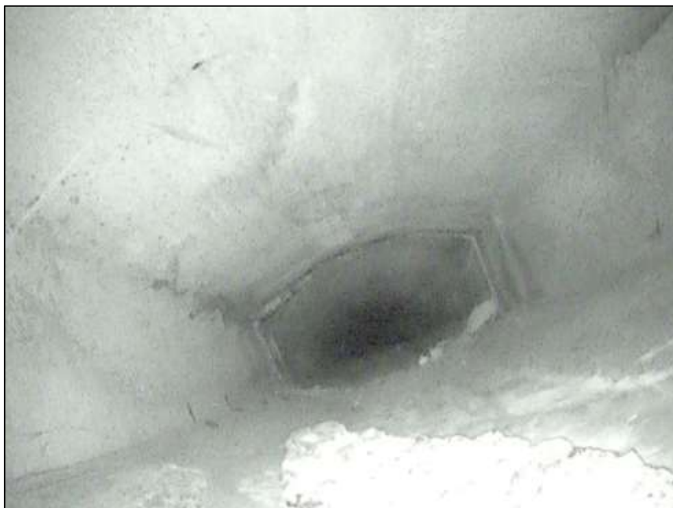
Foto 17: Detail vnitřního povrchu komory. Nosník č. 8, pole č. 2. Pohled směrem k opěře. Neaktivní stopy po průsacích spojené s výluhy. Lokální degradace povrchu betonu. Lokální koroze měkké výztuže nosníku.
