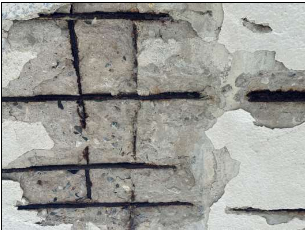
Foto 4: Monolitická část - Vykonzolovaná deska na konci nájezdu, patrné stopy po zatékání a degradace krycí vrstvy betonu, koroze obnažené betonářské výztuže NK
