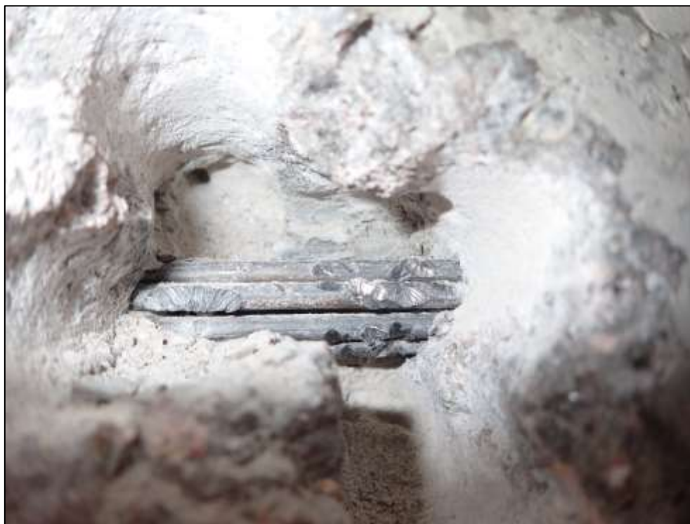
Foto 13: Detail sondy P13, předpínací výztuž, stěna nosníku č. 1, pole č. 1, poloha viz Příloha 1. Na předpínací výztuži byla nalezena koroze. Hodnocení korozního stavu předpínací výztuže: stupeň 2. Kanálek zcela vyplněn injektážní směsí. Krytí předpínací výztuže cca 40 mm.
