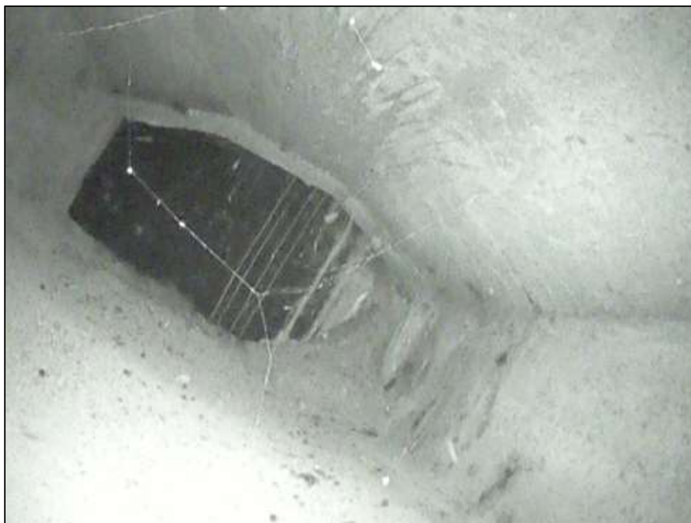
Foto 29: Detail vnitřního povrchu komory. Nosník č. 1, pole č. 1. Pohled směrem k opěře. S ohledem na poměrně značný podélný sklon nosníků je oblast v okolí odvodňovacího otvoru zanesena patrně nečistotami a stavebním materiálem. Lokální neaktivní stopy po průsacích spojené s výluhy.
