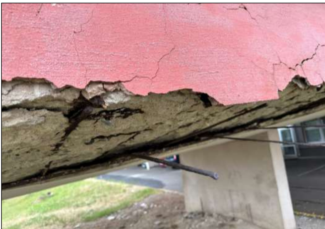
Foto 22: Monolitická část - Nájezd v oblasti dilatace, pohled zprava, patrné stopy po zatékání a degradace krycí vrstvy betonu, rozsáhlá koroze obnažené betonářské výztuže NK
