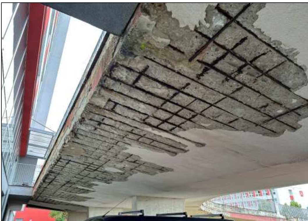
Foto 14: Monolitická část - Vykonzolovaná deska podél budovy, patrné stopy po zatékání a plošná degradace krycí vrstvy betonu – částečně již opadaná, koroze obnažené betonářské výztuže NK
