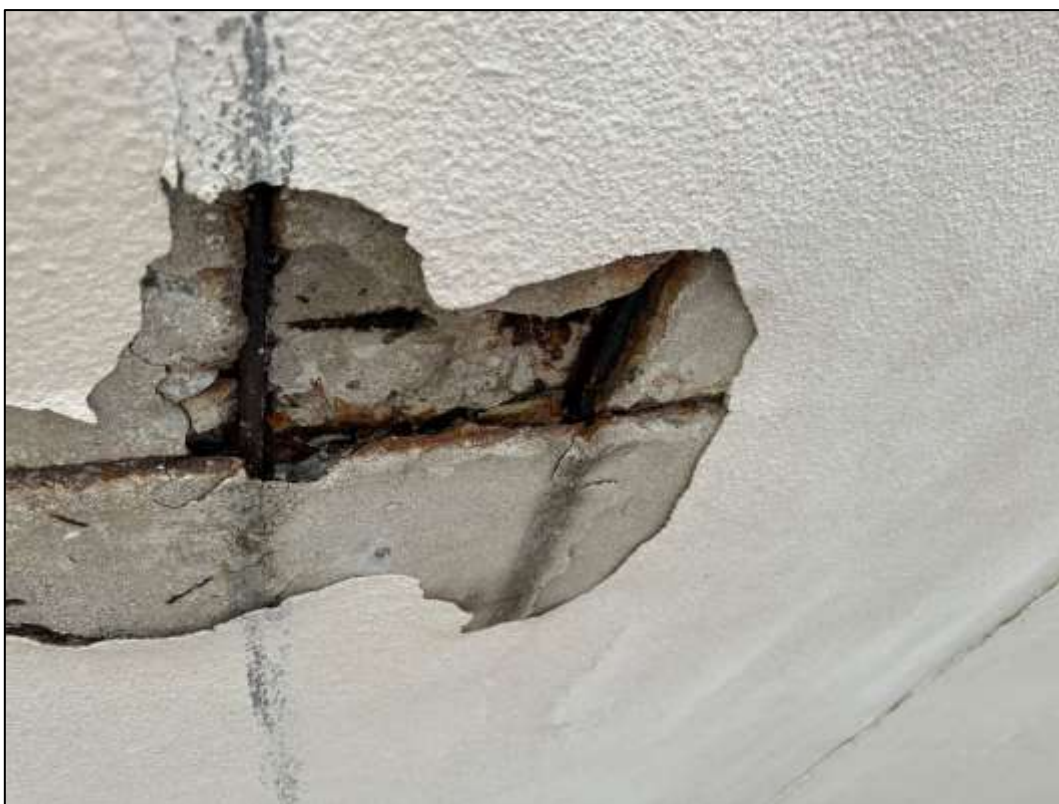
Foto 18: Monolitická část - Nájezd v oblasti dilatace, patrné stopy po zatékání a akusticky zřejmá nesoudržná krycí vrstva betonu, koroze betonářské výztuže NK
