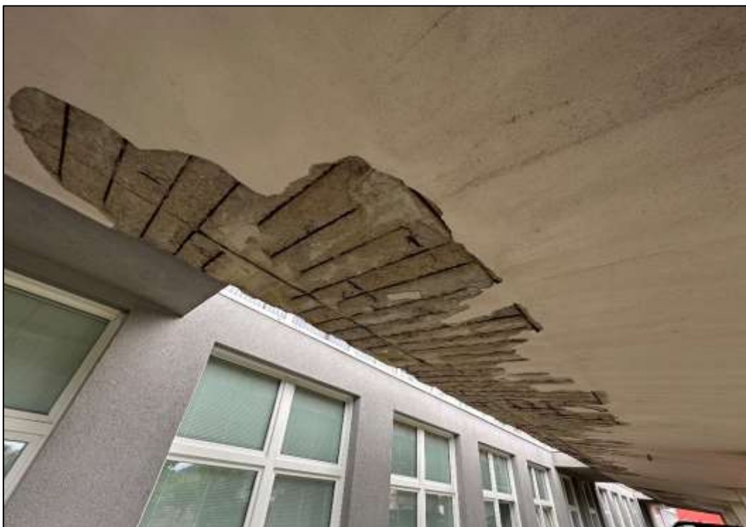
Foto 11: Monolitická část - Vykonzolovaná deska podél budovy, patrné stopy po zatékání a plošná degradace krycí vrstvy betonu – částečně již opadaná, koroze obnažené betonářské výztuže NK
