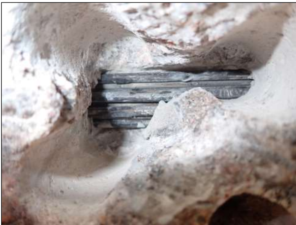
Foto 9: Detail sondy P9, předpínací výztuž, spodní líc nosníku č. 5, pole č. 2, poloha viz Příloha 1. Na předpínací výztuži byla nalezena korozie. Hodnocení korozního stavu předpínací výztuže: stupeň 2. Kanálek vyplněn injektážní směsí částečně. Krytí předpínací výztuže cca 55 mm.
