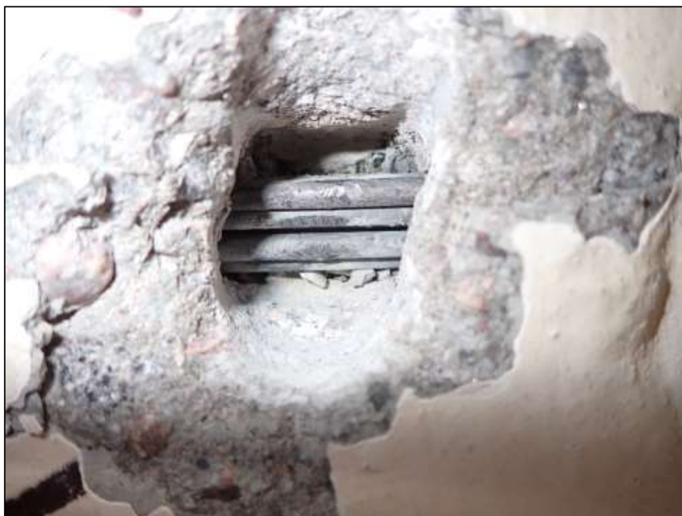
Foto 16: Detail sondy P16, kotva předpínací výztuže, spodní líc nosníku č. 6, pole č. 1, poloha viz Příloha 1. Na předpínací výztuži byla nalezena korozе. Hodnocení korozního stavu přepínací výztuže: stupeň 2. Kanálek zcela vyplněn injektážní směsí. Krytí předpínací výztuže cca 25 mm.
