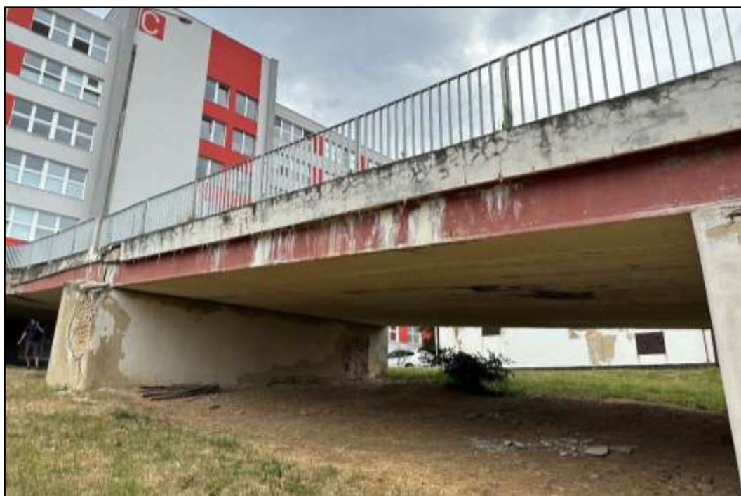
Foto 41: Prefabrikovaná část – Pole 3, pohled zleva, lokální stopy po zatékání mezi jednotlivé nosníky a silné stopy s výluhy na boku 1. nosníku
