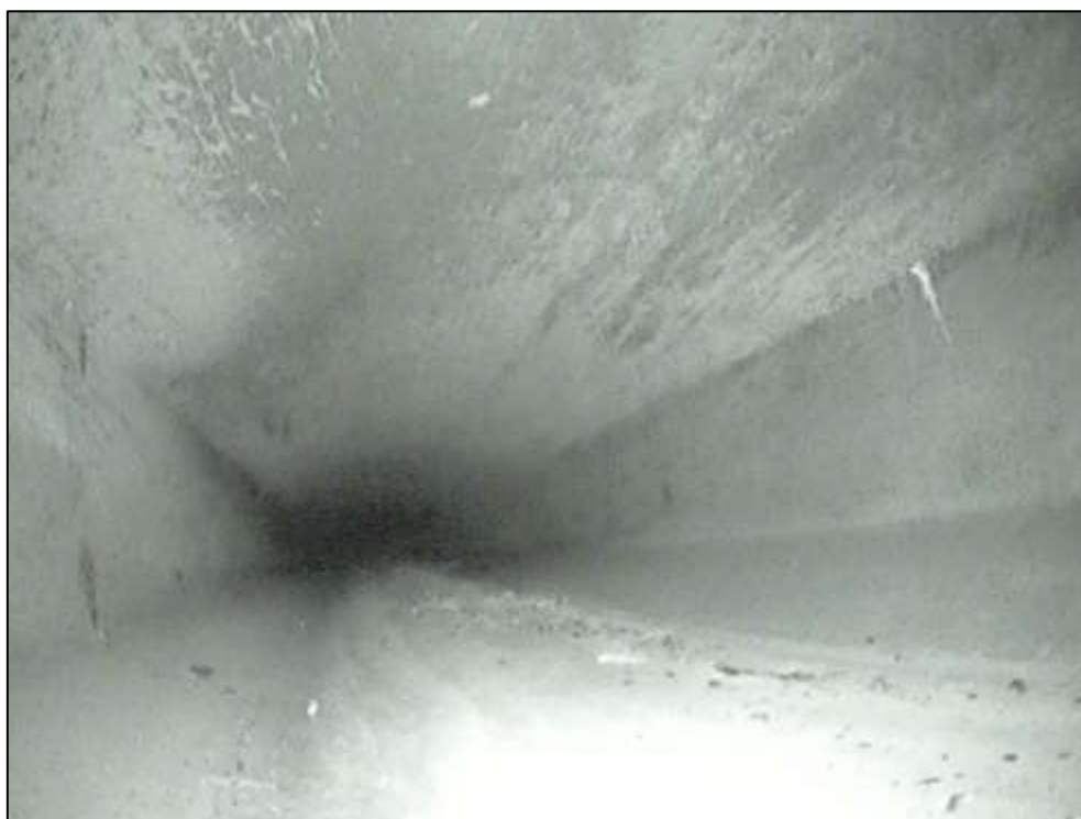
Foto 8: Detail vnitřního povrchu komory. Nosník č. 8, pole č. 3. Pohled směrem ke středu rozpětí. Neaktivní stopy po průsacích spojené s výluhy. Lokální degradace povrchu betonu. Lokální koroze měkké výztuže nosníku.
