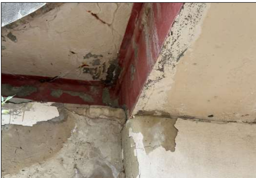
Foto 36: Prefabrikovaná část – Opěrná zeď P1, pohled zprava, patrné zatékání na konstrukci a degradace krycí vrstvy betonu s korozi obnažené výztuže v místě uložení
