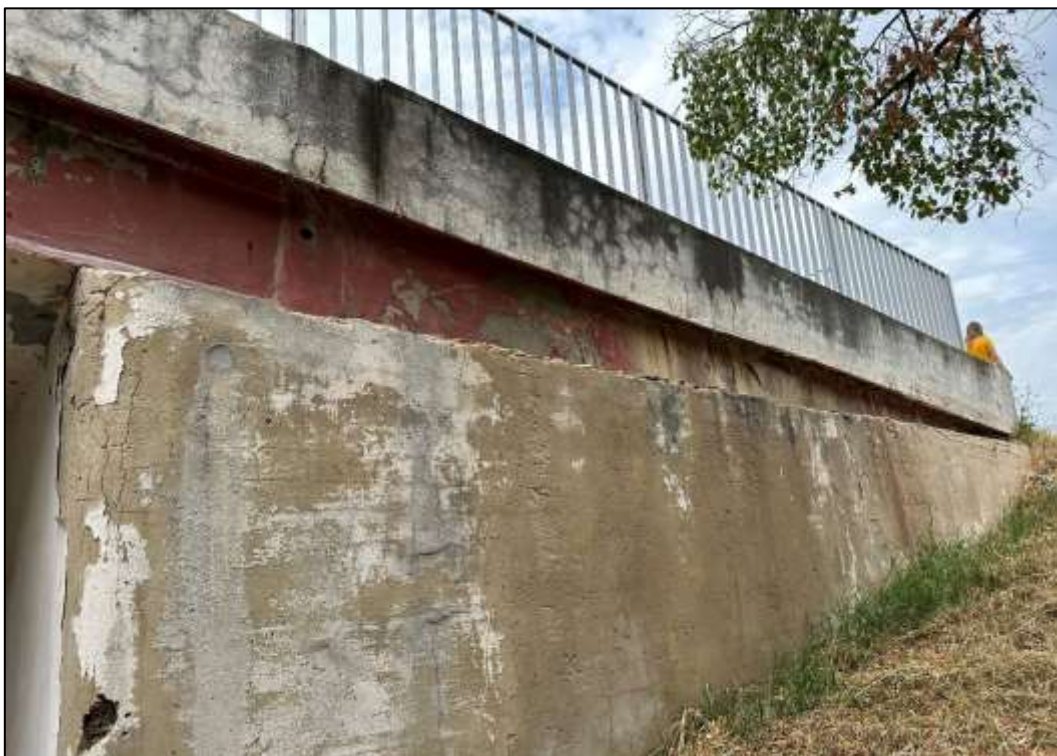
Foto 35: Prefabrikovaná část – Opěrná zeď P1, pohled zleva, patrné zatékání na konstrukci a degradace krycí vrstvy betonu s korozi obnažené výztuže v místě uložení
