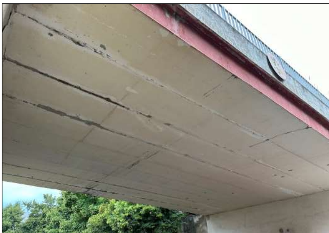
Foto 38: Prefabrikovaná část – Pole 1, pohled zleva na spodní líc NK, lokální stopy po zatékání mezi jednotlivé nosníky a stékání vody po římsce
