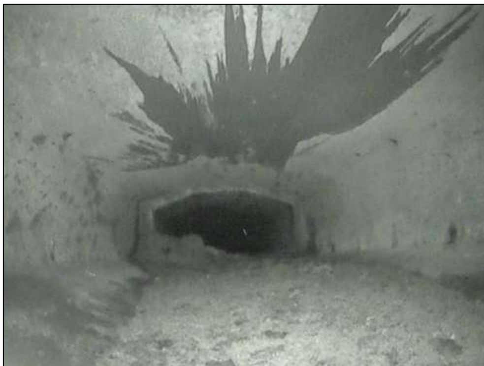
Foto 1: Detail vnitřního povrchu komory. Nosník č. 3, pole č. 3. Pohled směrem k opěře. Neaktivní stopy po průsacích spojené s výluhy. Lokální degradace povrchu betonu. Lokální koroze měkké výztuže nosníku.
