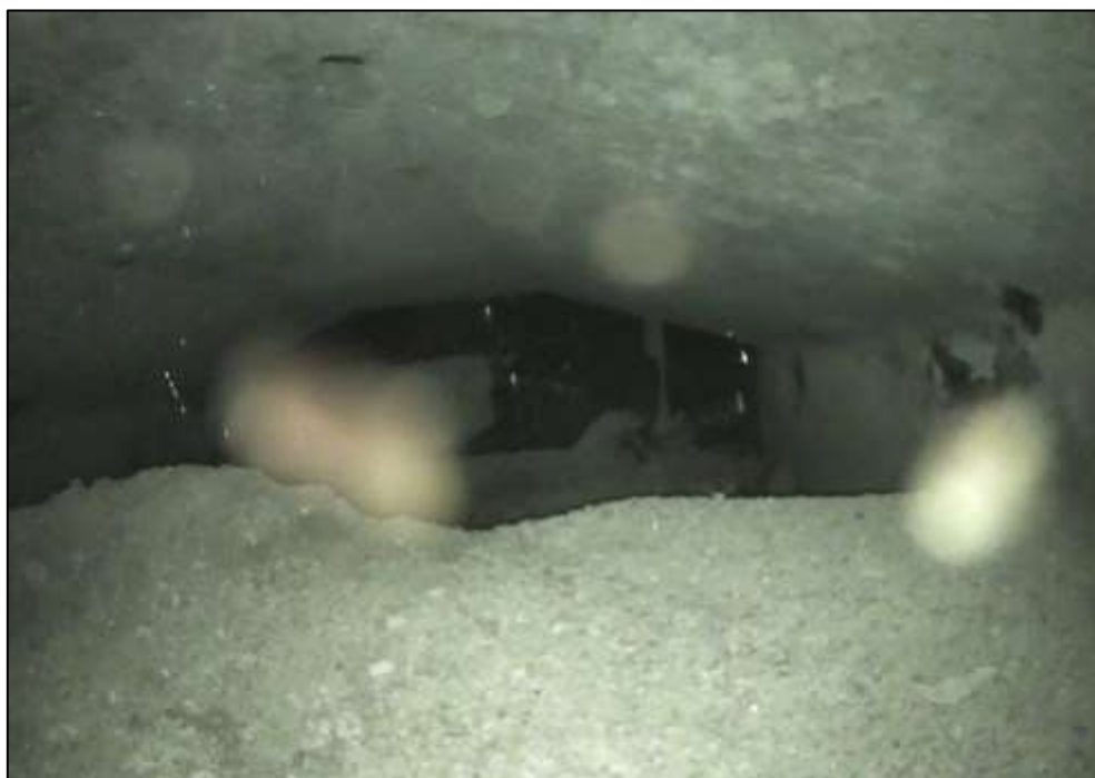
Foto 25: Detail vnitřního povrchu komory. Nosník č. 5, pole č. 1. Pohled směrem k opěře. S ohledem na poměrně značný podélný sklon nosníků je oblast v okolí odvodňovacího otvoru zanesena patrně nečistotami a stavebním materiálem. Lokální neaktivní stopy po průsacích spojené s výluhy.
