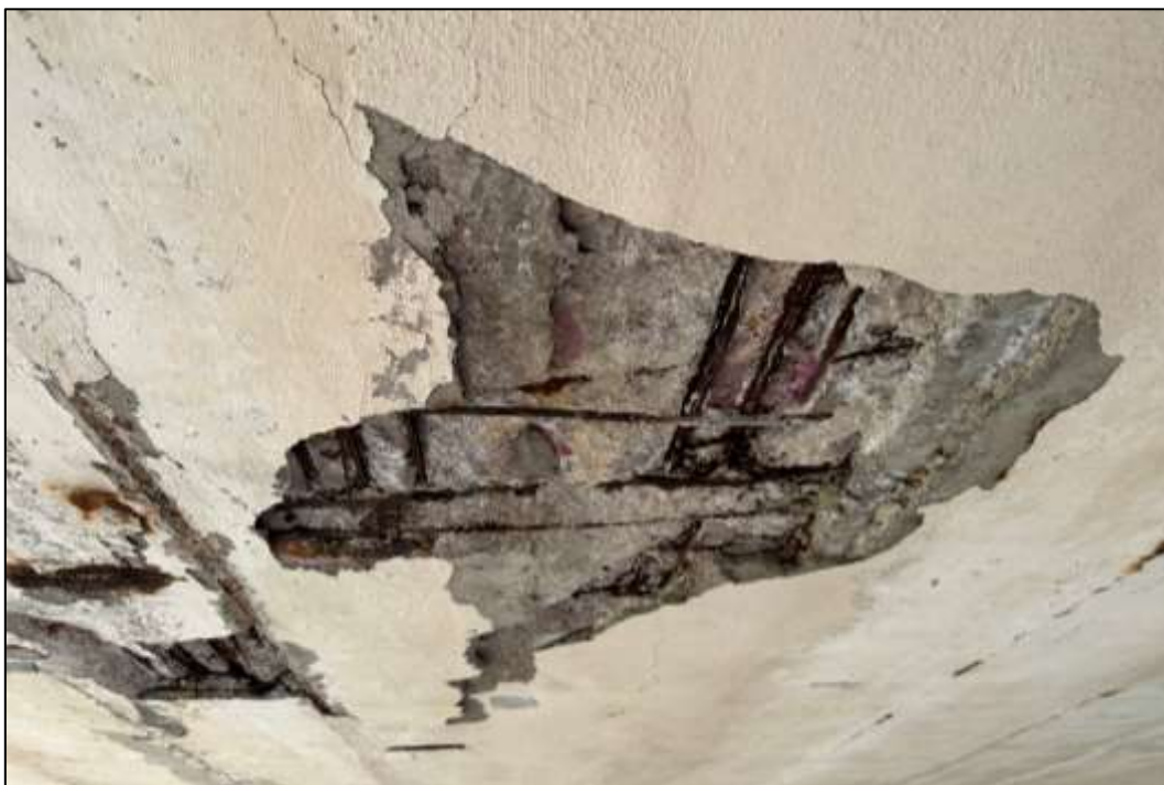
Foto 45: Prefabrikovaná část – Pole 3, na nosnících č. 3 a 4 jsou značné stopy po zatékání a ve velké míře je poškozena krycí vrstva betonu a předpínací výztuž při spodním lici obou nosníků. Jedná se o několik lan, která jsou zcela překorodována
