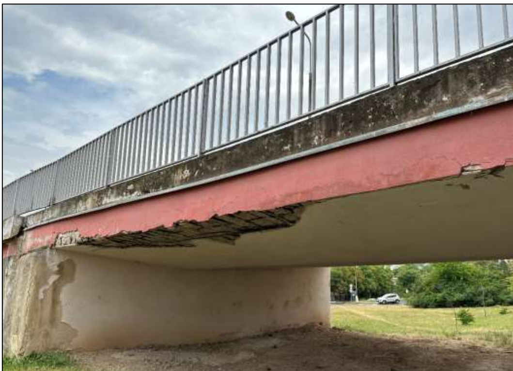
Foto 21: Monolitická část - Nájezd v oblasti dilatace, pohled zprava, patrné stopy po zatékání a akusticky zřejmá nesoudržná krycí vrstva betonu – částečně již opadaná, koroze obnažené betonářské výztuže NK
