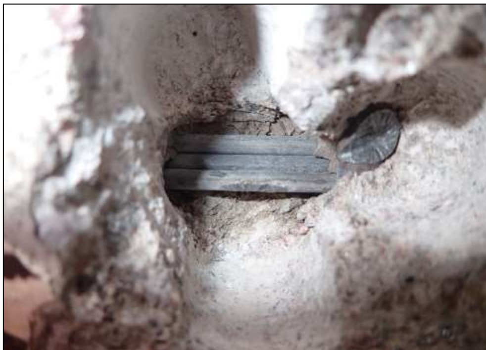
Foto 15: Detail sondy P15, předpínací výztuž, spodní líc nosníku č. 3, pole č. 1, poloha viz Příloha 1. Na předpínací výztuži byla nalezena korozе. Hodnocení korozního stavu přepínací výztuže: stupeň 2. Chránička zcela vyplněna injektážní směsí. Krytí předpínací výztuže cca 35 mm.
