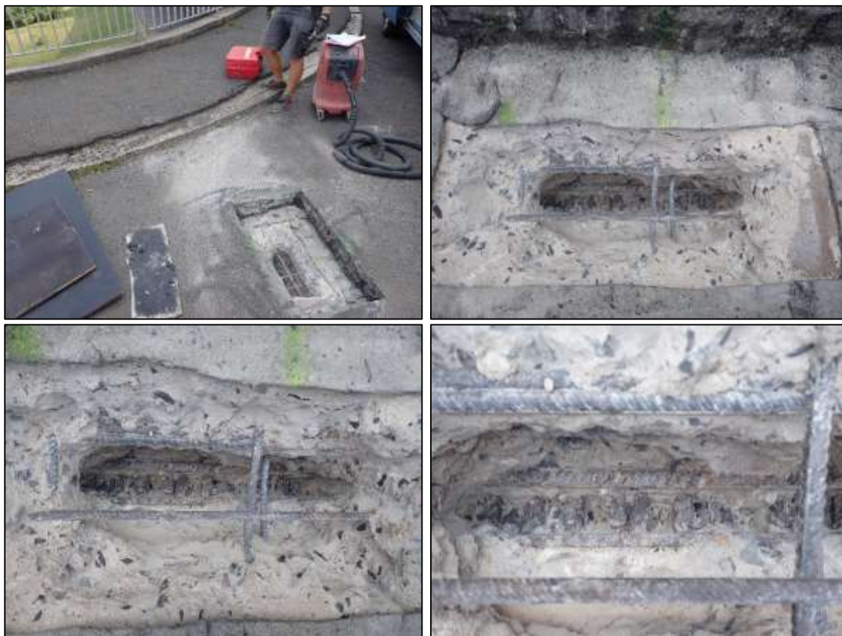
Foto 32: Detail sondy S12, monolitická část – deska nad pilířem (horní líc), poloha viz Příloha 1. Příčná a podélná výztuž. Povrchová koroze (P) bez oslabení plochy průřezu.
