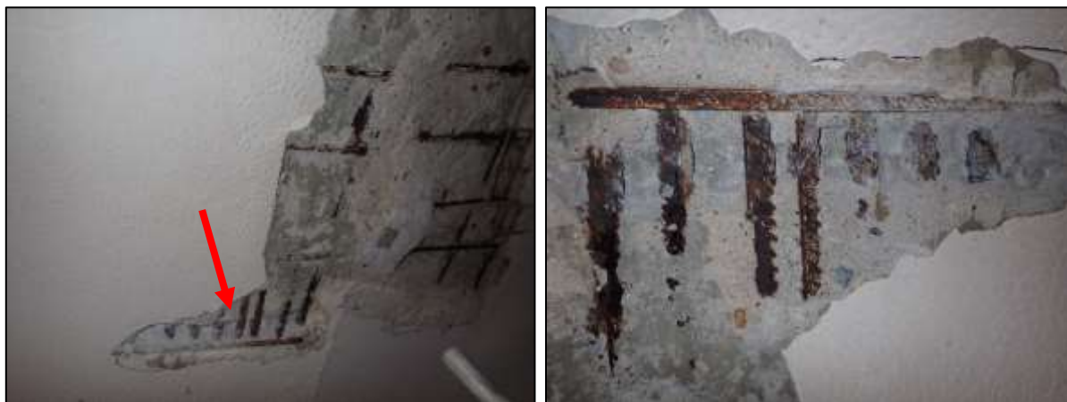
Foto 29: Detail sondy S9, monolitická část – deska mezi sloupy (spodní líc), poloha viz Příloha 1. Příčná a podélná výztuž. Povrchová koroze (P) s oslabením plochy průřezu do 5 %. Nesoudržná krycí vrstva betonu, částečně opadané, koroze obnažené výztuže.
