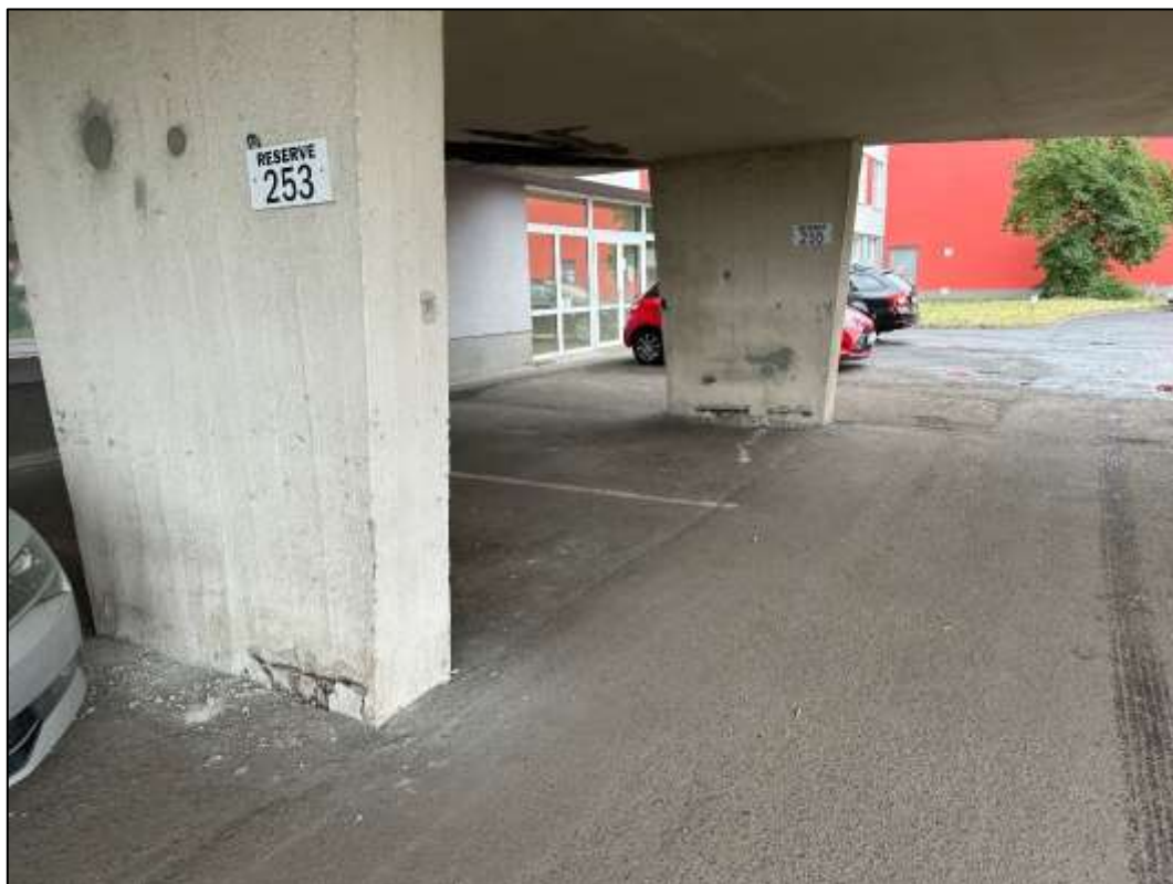
Foto 7: Monolitická část - Pohled na pilíře, odprýsknutá krycí vrstva betonu v patě pilířů, koroze lokálně obnažené výztuže
