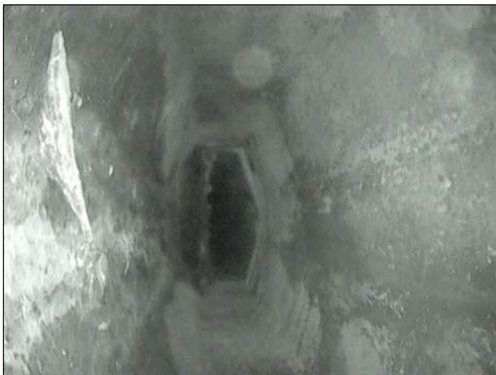
Foto 5: Detail vnitřního povrchu komory. Nosník č. 5, pole č. 3. Pohled směrem k opěře. Neaktivní stopy po průsacích spojené s výluhy. Lokální degradace povrchu betonu. Lokální koroze měkké výztuže nosníku.
