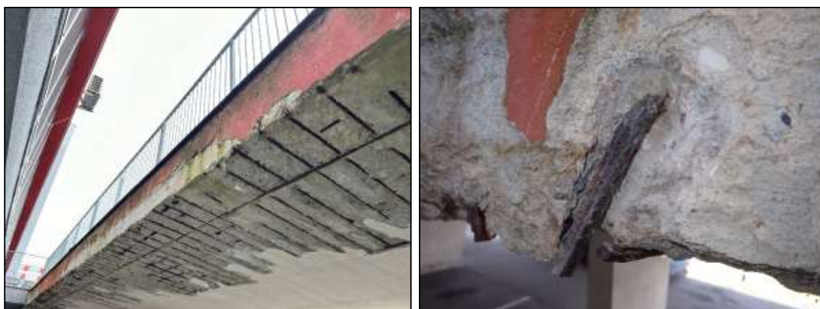
Foto 28: Detail sondy S8, monolitická část – konzola desky (bok), poloha viz Příloha 1. Příčná výztuž. Hloubková koroze (H) s oslabením plochy průřezu do 15 %. Nesoudržná krycí vrstva betonu, částečné opadané, koroze obnažené výztuže, stopy po zatékání.
