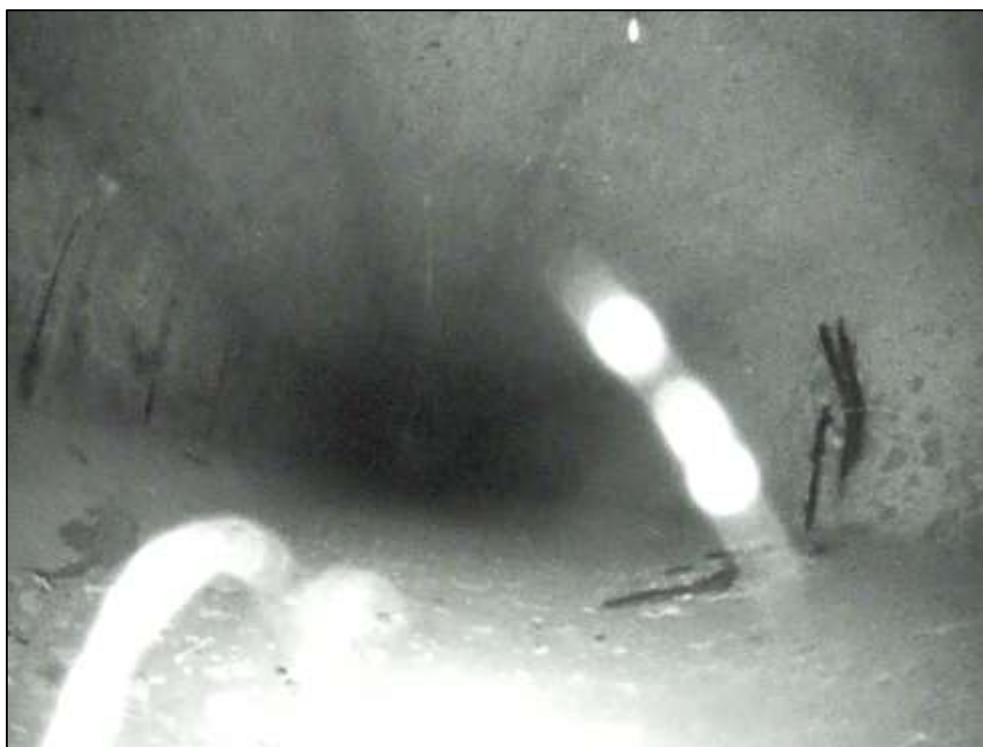
Foto 12: Detail vnitřního povrchu komory. Nosník č. 1, pole č. 2. Pohled směrem ke středu rozpětí. Neaktivní stopy po průsacích spojené s výluhy. Lokální degradace povrchu betonu. Lokální koroze měkké výztuže nosníku.
