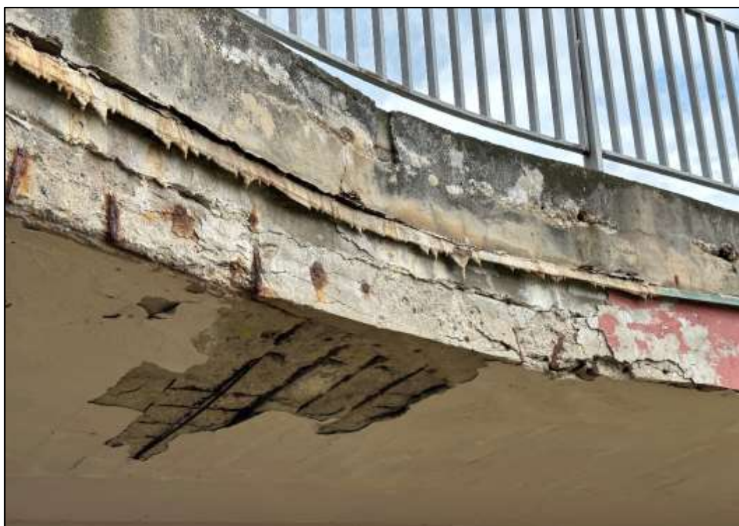
Foto 24: Monolitická část - Nájezd v oblasti dilatace, pohled zleva, patrné stopy po zatékání a akusticky zřejmá nesoudržná krycí vrstva betonu – částečně již opadaná, koroze obnažené betonářské výztuže NK
