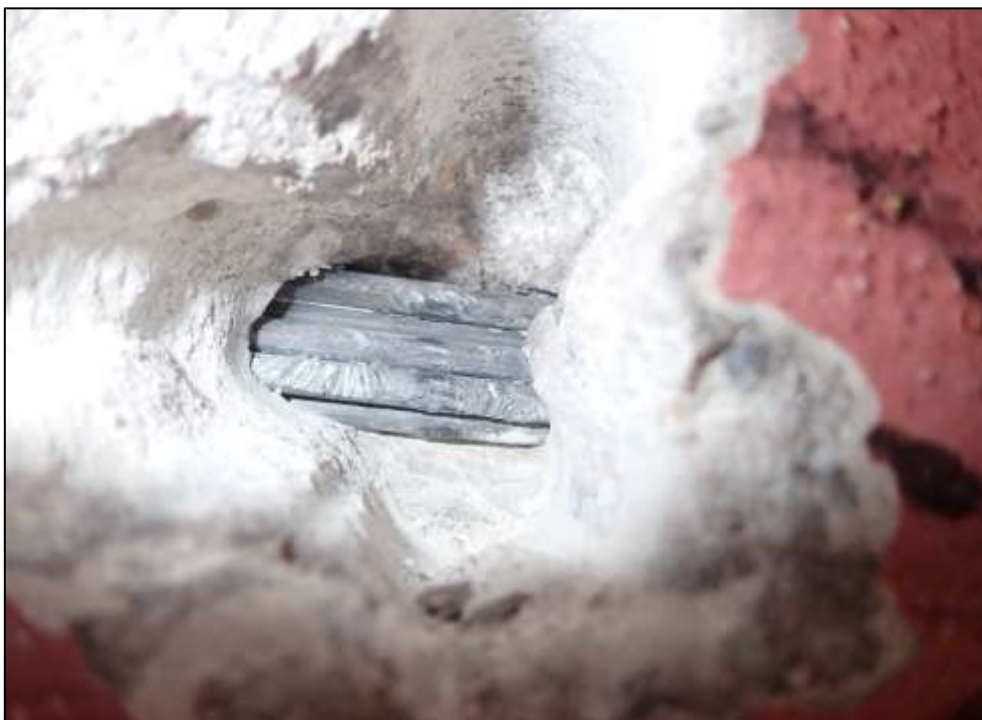
Foto 7: Detail sondy P7, předpínací výztuž, stěna nosníku č. 1, pole č. 2, poloha viz Příloha 1. Na předpínací výztuži byla nalezena korozie. Hodnocení korozního stavu předpínací výztuže: stupeň 2. Kanálek vyplněn injektážní směsí částečně. Krytí předpínací výztuže cca 45 mm.
