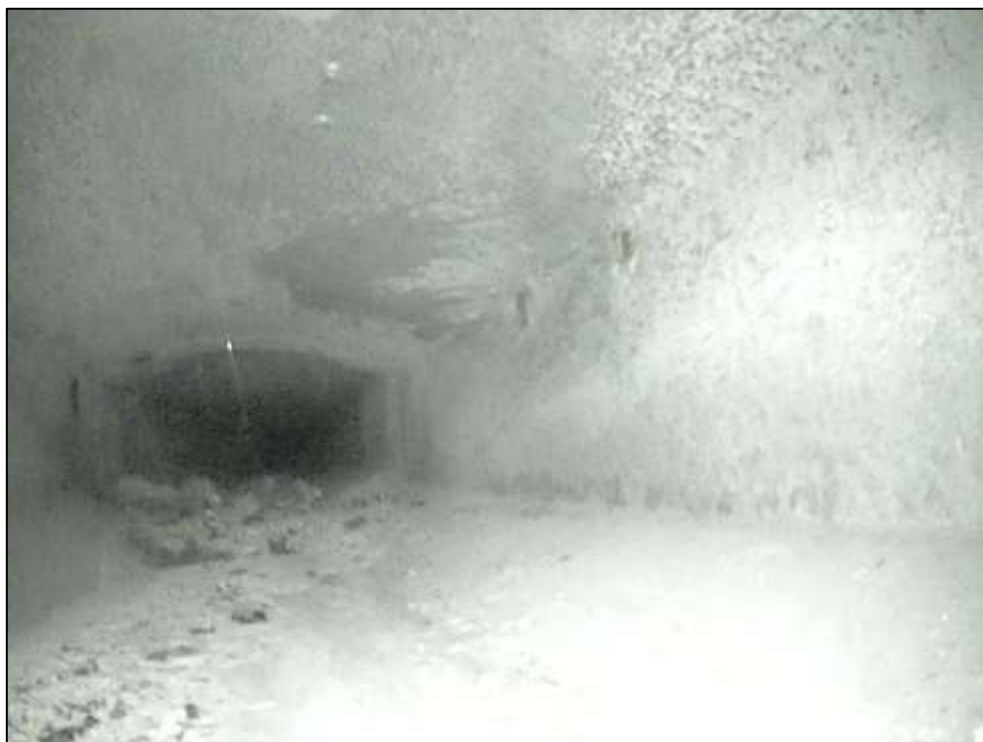
Foto 7: Detail vnitřního povrchu komory. Nosník č. 8, pole č. 3. Pohled směrem k opěře. Neaktivní stopy po průsacích spojené s výluhy. Lokální degradace povrchu betonu. Lokální koroze měkké výztuže nosníku.
