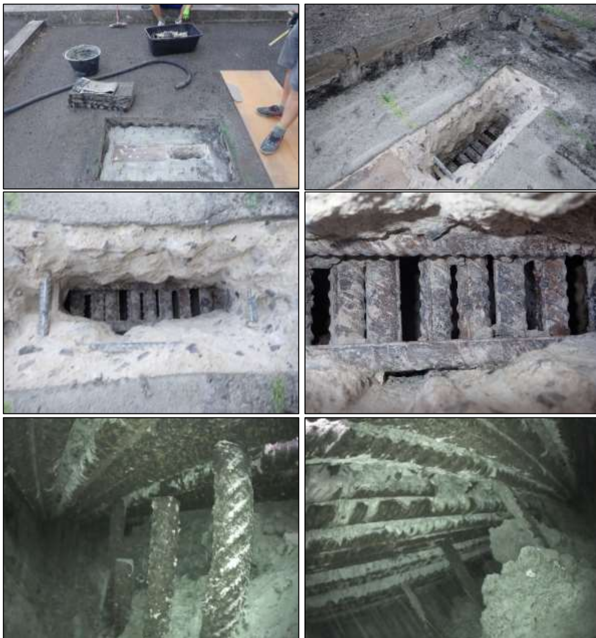
Foto 31: Detail sondy S11, monolitická část – deska nad pilířem (horní líc), poloha viz Příloha 1. Příčná a podélná výztuž. Povrchová koroze (P) bez oslabení plochy průřezu. S ohledem na husté vyztužení neprobetonováno v místě sondy cca do hl. 200 mm, dle snímků z videoskopu se nejedná pouze o lokální vadu.
