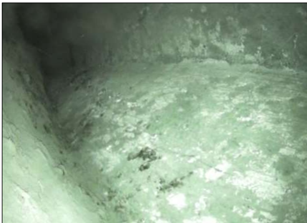
Foto 22: Detail vnitřního povrchu komory. Nosník č. 9, pole č. 1. Pohled směrem ke středu rozpětí. S ohledem na poměrně značný podélný sklon nosníků je oblast v okolí odvodňovacího otvoru zanesena patrně nečistotami a stavebním materiálem. Neaktivní stopy po průsacích spojené s výluhy. Lokální degradace povrchu betonu.
