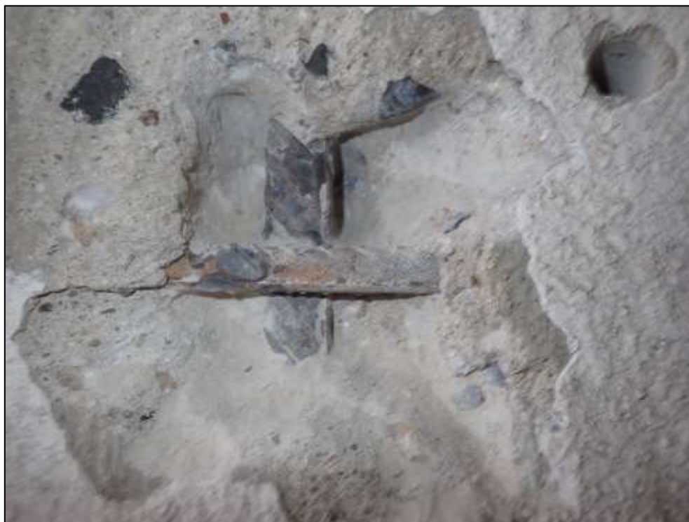
Foto 21: Detail sondy S1, monolitická část – pilíř, poloha viz Příloha 1. Svislá a vodorovná výztuž. Povrchová koroze (P) bez oslabení plochy průřezu.
