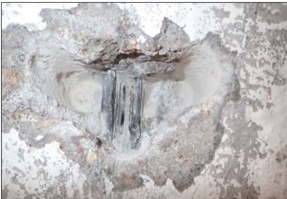
Foto 5: Detail sondy P5, předpínací výztuž, spodní líc nosníku č. 6, pole č. 3, poloha viz Příloha 1. Na předpínací výztuži byla nalezena koroze. Hodnocení korozního stavu předpínací výztuže: stupeň 2. Kanálek zcela vyplněn injektážní směsí. Krytí předpínací výztuže cca 35 mm.
