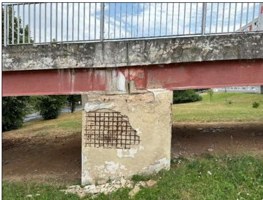
Foto 32: Prefabrikovaná část – Pilíř P3 mezi polem 2 a 3, pohled zprava, patrné zatékání na konstrukci a degradace krycí vrstvy betonu s korozi obnažené výztuže
