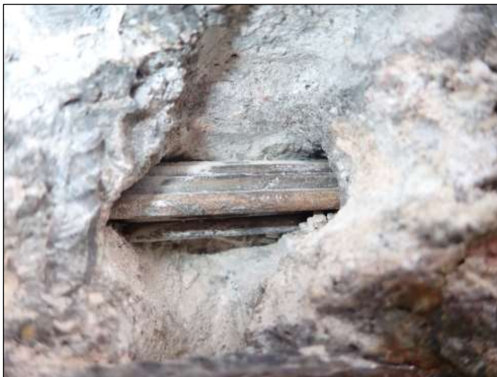
Foto 12: Detail sondy P12, předpínací výztuž, stěna nosníku č. 9, pole č. 2, poloha viz Příloha 1. Na předpínací výztuži byla nalezena koroze. Hodnocení korozního stavu přepínací výztuže: stupeň 3. Kanálek vyplněn injektážní směsí částečně. Krytí předpínací výztuže cca 45 mm.
