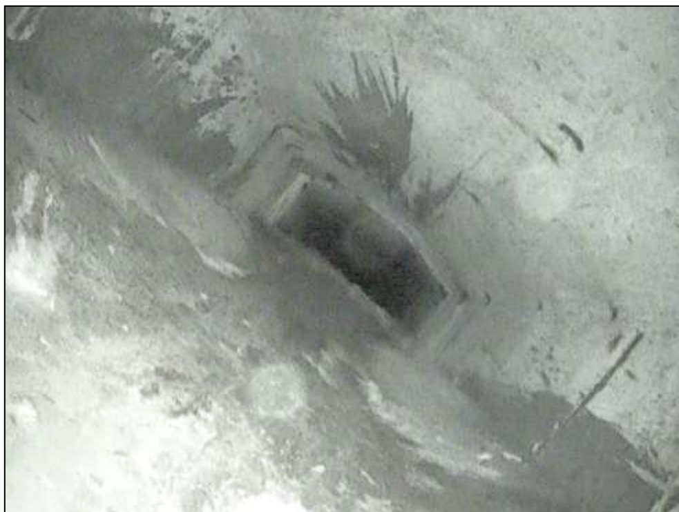
Foto 3: Detail vnitřního povrchu komory. Nosník č. 4, pole č. 3. Pohled směrem k opěře. Neaktivní stopy po průsacích spojené s výluhy. Lokální degradace povrchu betonu. Lokální koroze měkké výztuže nosníku.
