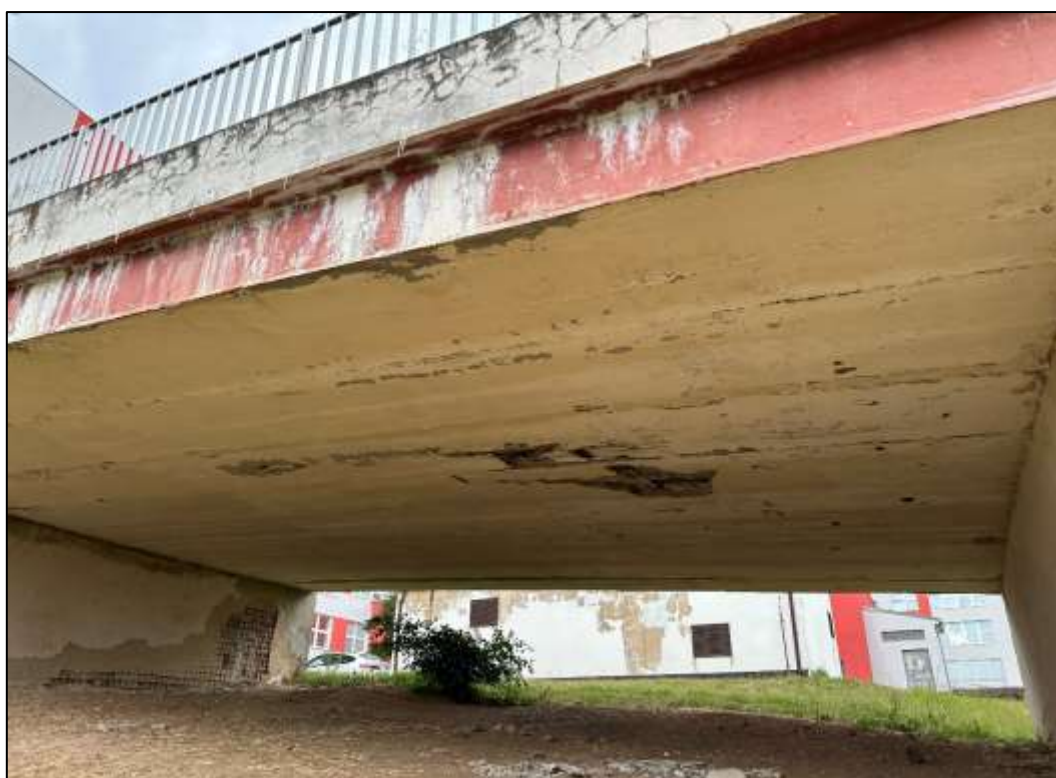
Foto 42: Prefabrikovaná část – Pole 3, pohled zleva na spodní líc NK, lokální stopy po zatékání mezi jednotlivé nosníky, zejména na nosnicích č. 3 a 4 jsou značné stopy po zatékání a ve velké míře je poškozena krycí vrstva betonu a předpínací výztuž při spodním lící obou nosníků. Jedná se o několik lan, která jsou zcela překorodována
