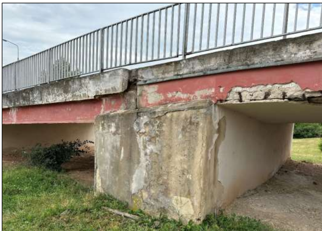
Foto 30: Prefabrikovaná část – Pilíř P4 mezi prefabrikovanou a monolitickou částí mostu, pohled zprava, patrné zatékání na konstrukci a degradace krycí vrstvy betonu s korozí obnažené výztuže
