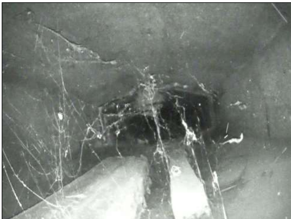
Foto 19: Detail vnitřního povrchu komory. Nosník č. 9, pole č. 2. Pohled směrem k opěře. Neaktivní stopy po průsacích spojené s výluhy. Lokální degradace povrchu betonu. Lokální koroze měkké výztuže nosníku.
