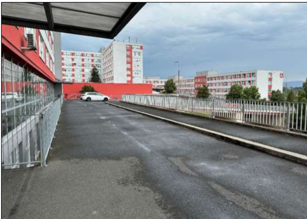
Foto 48: Monolitická část – Pohled na mostní svršek, lokálně patrná náletová vegetace v oblasti obrubníku a říms
