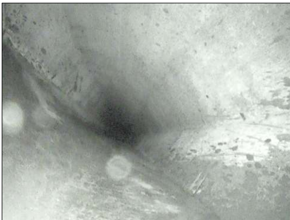
Foto 4: Detail vnitřního povrchu komory. Nosník č. 4, pole č. 3. Pohled směrem ke středu rozpětí. Neaktivní stopy po průsacích spojené s výluhy. Lokální degradace povrchu betonu. Lokální koroze měkké výztuže nosníku.
