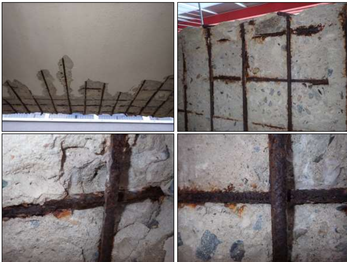
Foto 27: Detail sondy S7, monolitická část – konzola desky (spodní líc), poloha viz Příloha 1. Příčná a podélná výztuž. Hloubková koroze (H) s oslabením plochy průřezu do 15 %. Nesoudržná krycí vrstva betonu, částečné opadané, koroze obnažené výztuže.
