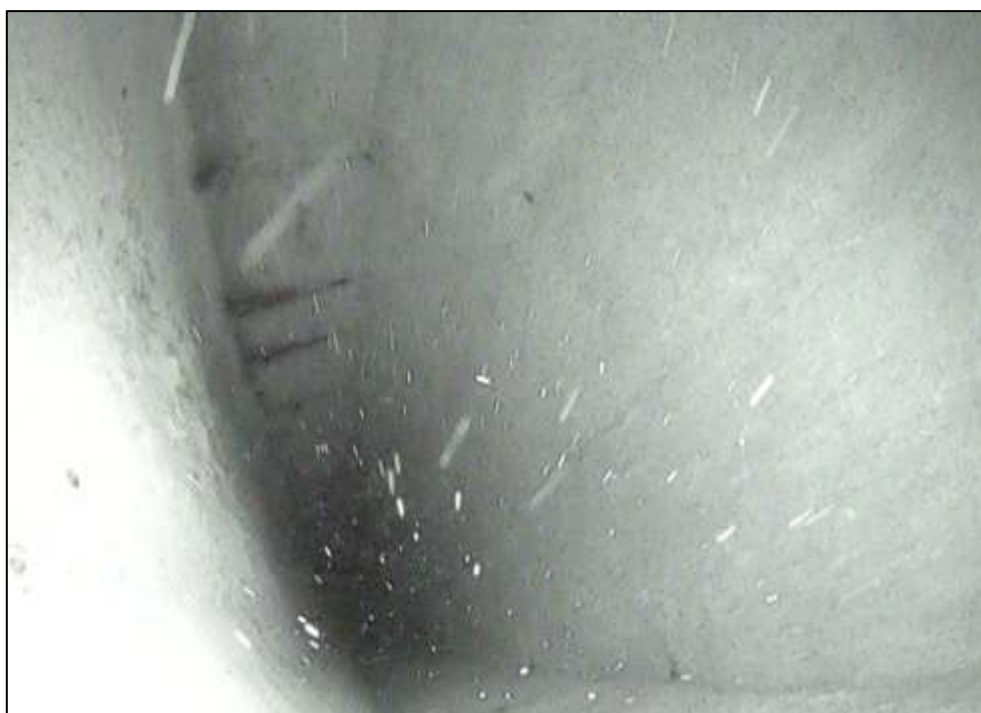
Foto 30: Detail vnitřního povrchu komory. Nosník č. 1, pole č. 1. Pohled směrem ke středu rozpětí. S ohledem na poměrně značný podélný sklon nosníků je oblast v okolí odvodňovacího otvoru zanesena patrně nečistotami a stavebním materiálem. Neaktivní stopy po průsacích spojené s výluhy. Lokální degradace povrchu betonu.
