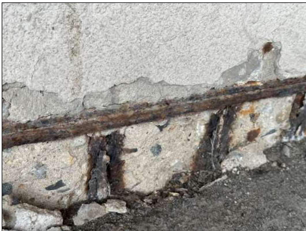
Foto 8: Monolitická část - Pohled na pilíře, odprýsknutá krycí vrstva betonu v patě pilířů, koroze obnažené výztuže
