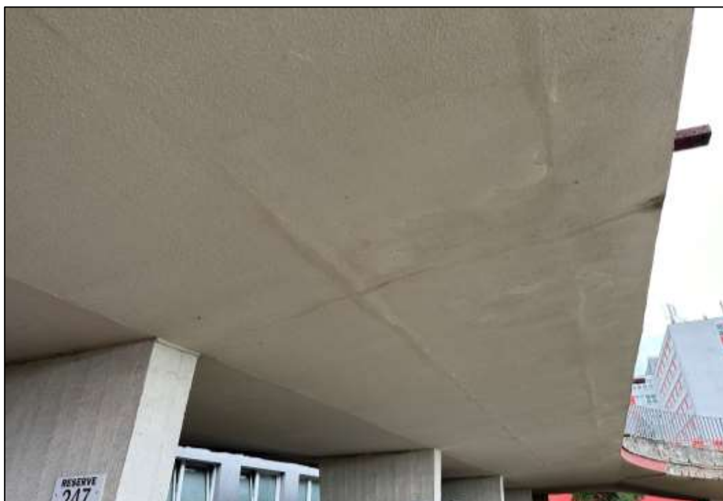
Foto 15: Monolitická část - Vykonzolovaná deska, na spodním lící NK akusticky patrná lokálně nesoudržná krycí vrstva betonu
