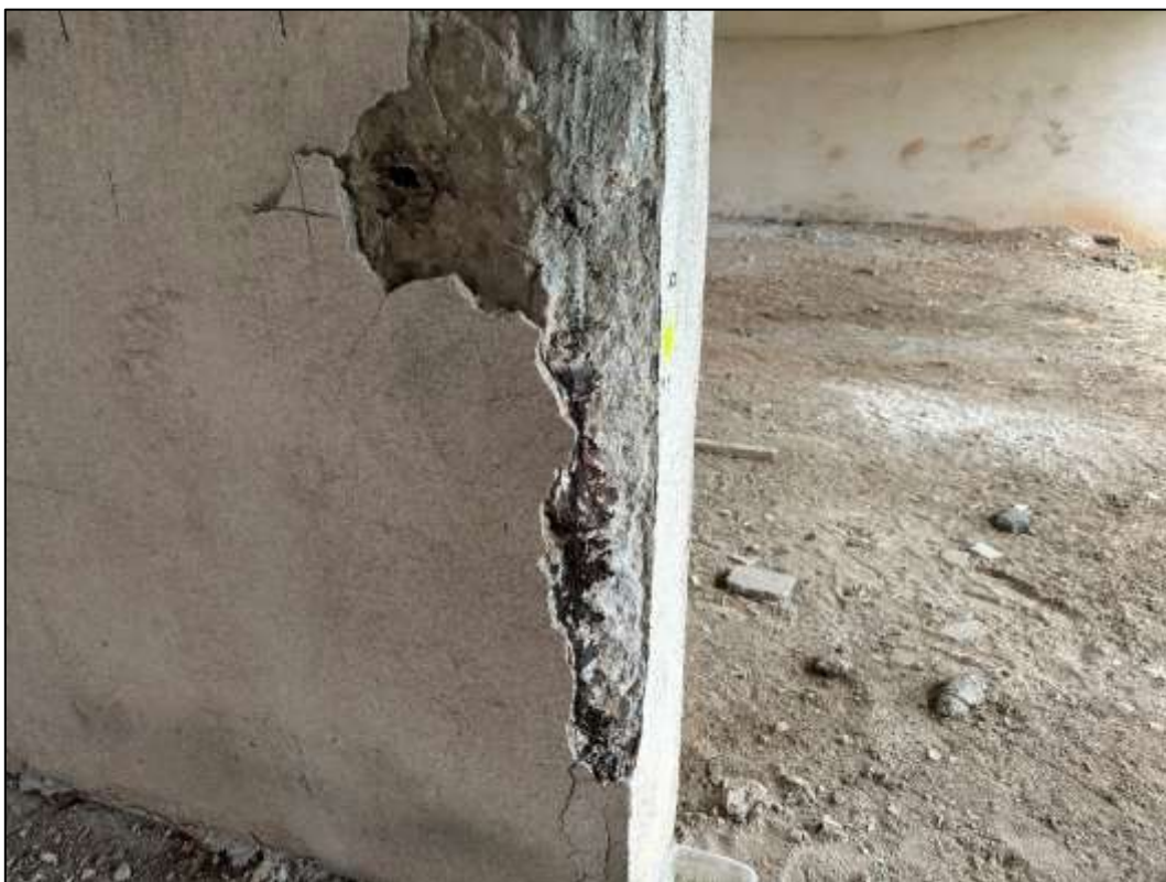
Foto 10: Monolitická část - Pohled na pilíř u dilatace rampy, po výšce pilíře patrné porušení rohů, koroze obnažené výztuže
