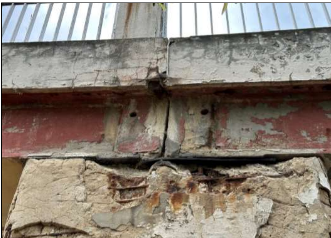
Foto 34: Prefabrikovaná část – Pilíř P2 mezi polem 1 a 2, pohled zleva, patrné zatékání na konstrukci a degradace krycí vrstvy betonu s korozi obnažené výztuže, zatékání na čela nosníků
