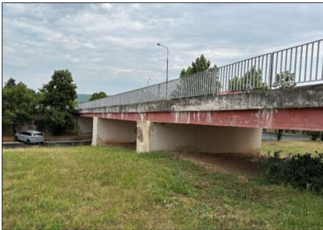
Foto 28: Prefabrikovaná část – Pole 1 až 3, pohled zprava, plošně patrné zatékání na konstrukci a degradace krycí vrstvy betonu – částečně již opadaná, rozsáhlá korozie obnažené betonářské výztuže zejména dodatečné výztuže zesílených pilířů
