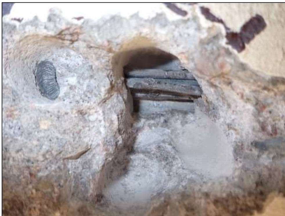
Foto 8: Detail sondy P8, předpínací výztuž, spodní líc nosníku č. 2, pole č. 2, poloha viz Příloha 1. Na předpínací výztuži byla nalezena korozie. Hodnocení korozního stavu předpínací výztuže: stupeň 2. Kanálek zcela vyplněn injektážní směsí. Krytí předpínací výztuže cca 35 mm.
