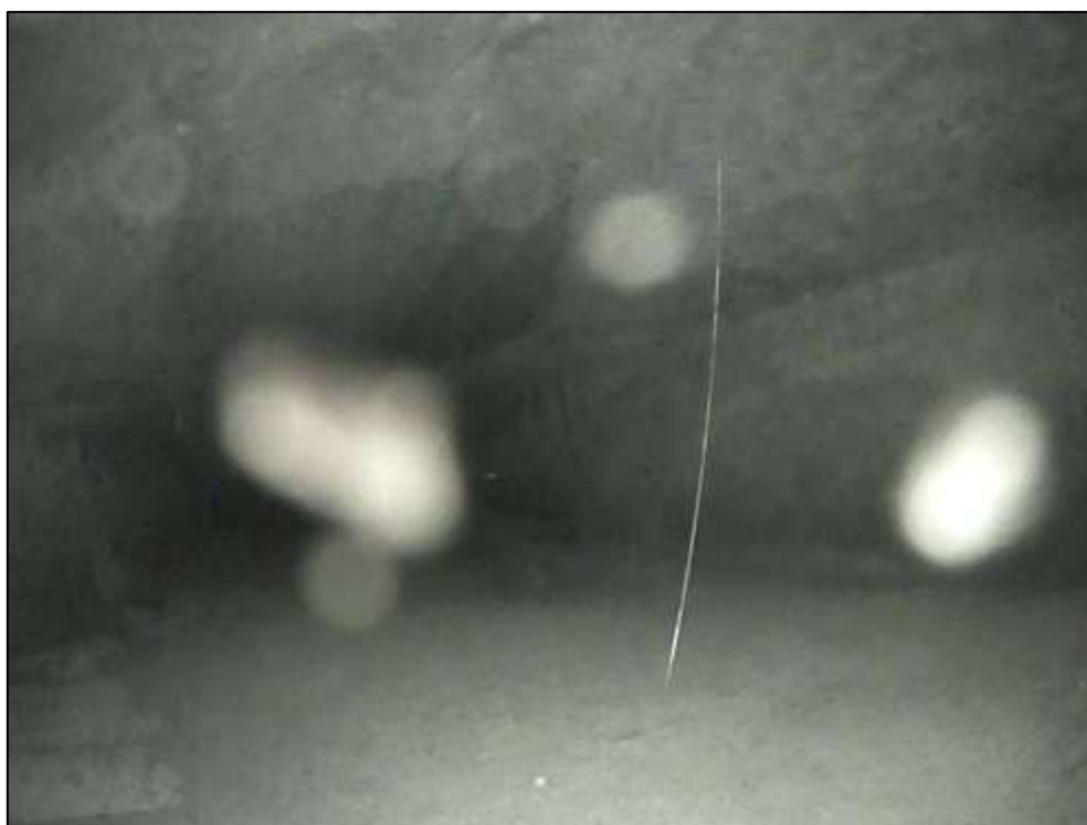
Foto 26: Detail vnitřního povrchu komory. Nosník č. 5, pole č. 1. Pohled směrem ke středu rozpětí. S ohledem na poměrně značný podélný sklon nosníků je oblast v okolí odvodňovacího otvoru zanesena patrně nečistotami a stavebním materiálem. Neaktivní stopy po průsacích spojené s výluhy. Lokální degradace povrchu betonu.
