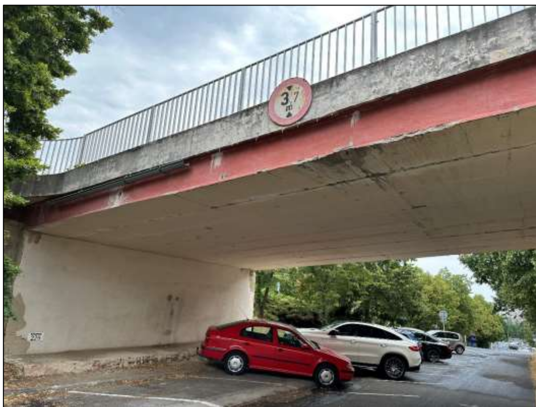
Foto 37: Prefabrikovaná část – Pole 1, pohled zprava, lokální stopy po zatékání mezi jednotlivé nosníky a stékání vody po římsce, hrana a spodní líc 9. nosníku povrchově poškozena od průjezdu vozidel
