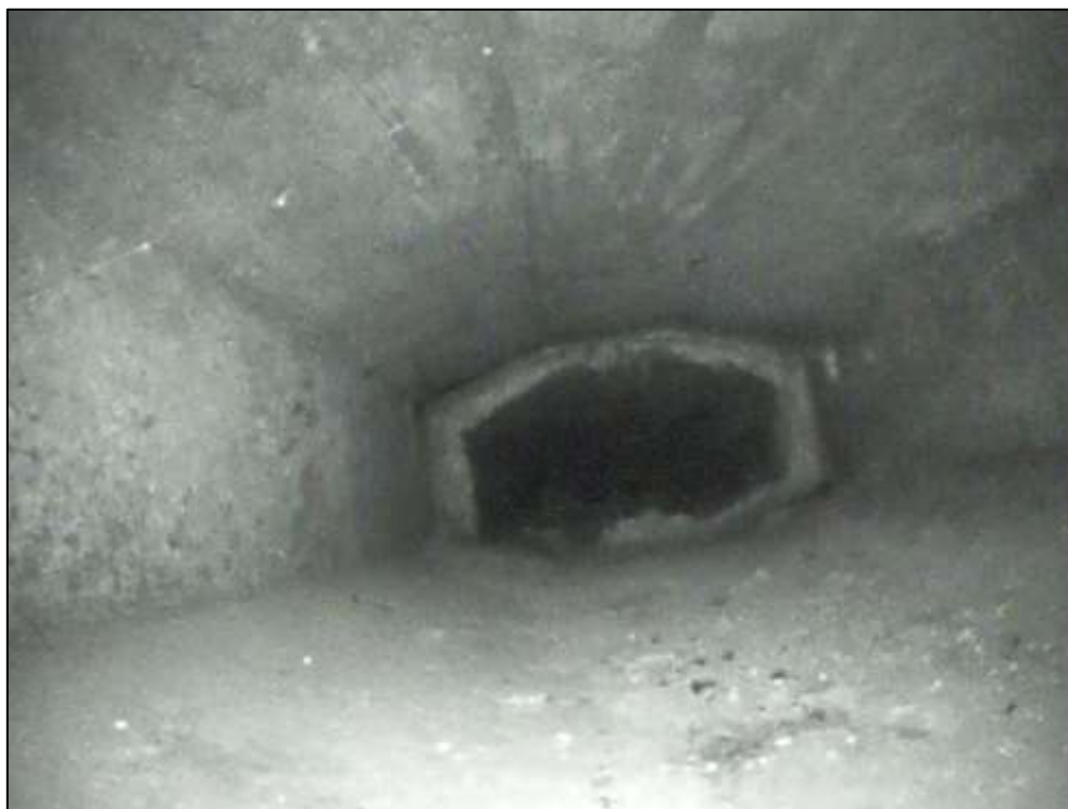
Foto 11: Detail vnitřního povrchu komory. Nosník č. 1, pole č. 2. Pohled směrem k opěře. Neaktivní stopy po průsacích spojené s výluhy. Lokální degradace povrchu betonu. Lokální koroze měkké výztuže nosníku.
