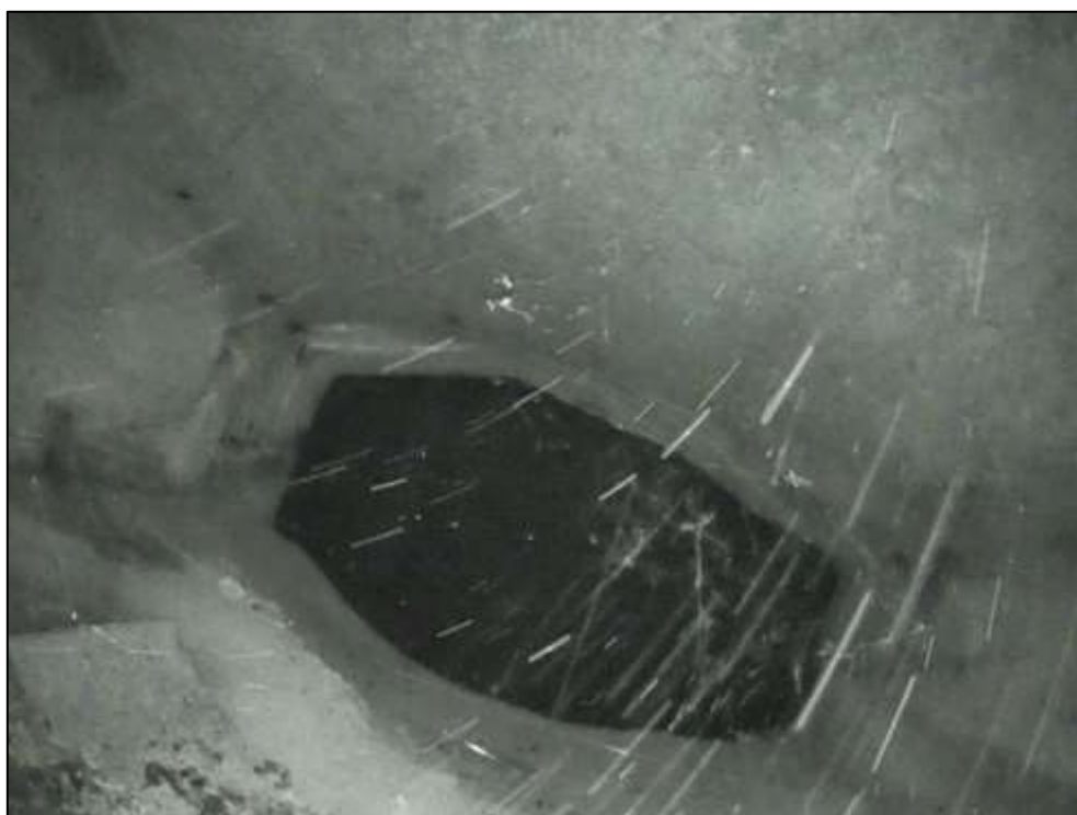
Foto 27: Detail vnitřního povrchu komory. Nosník č. 2, pole č. 1. Pohled směrem k opěře. S ohledem na poměrně značný podélný sklon nosníků je oblast v okolí odvodňovacího otvoru zanesena patrně nečistotami a stavebním materiálem. Lokální neaktivní stopy po průsacích spojené s výluhy.
