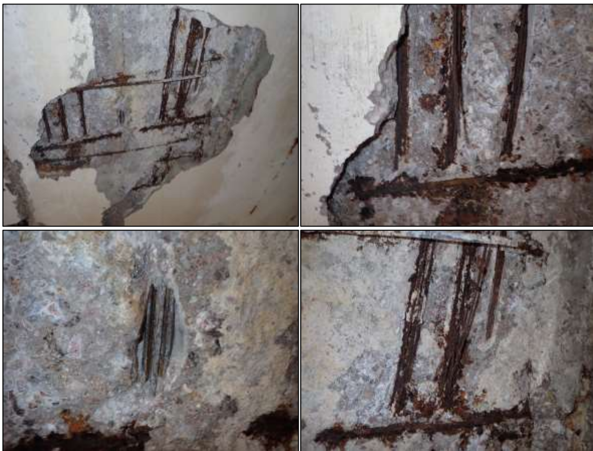
Foto 3: Detail sondy P3, předpínací výztuž, spodní líc nosníku č. 4, pole č. 3, poloha viz Příloha 1. Na předpínací výztuži byla nalezena rozsáhlá korozí. Hodnocení korozního stavu předpínací výztuže: stupeň 3 až 6. Kanálky částečně vyplněny injektážní směsí. Nesoudržná krycí vrstva betonu. Krytí předpínací výztuže cca 35-45 mm.
