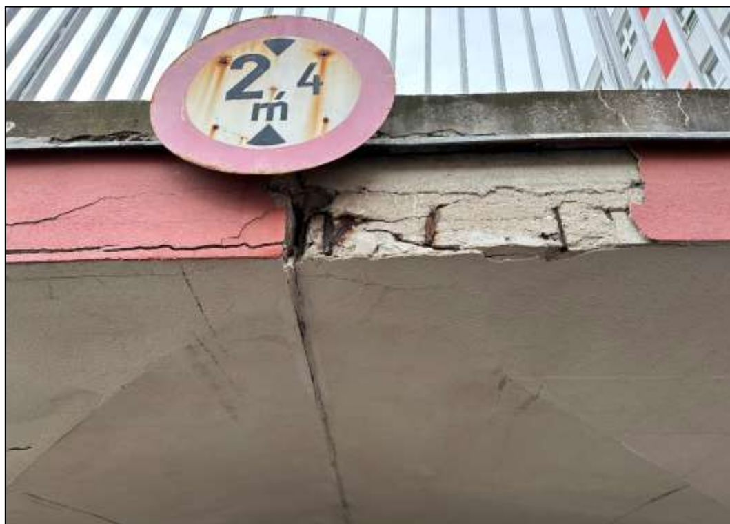
Foto 20: Monolitická část - Nájezd v oblasti dilatace, pohled zprava, patrné stopy po zatékání a degradace krycí vrstvy betonu zejména v oblasti dilatace, koroze obnažené betonářské výztuže NK
