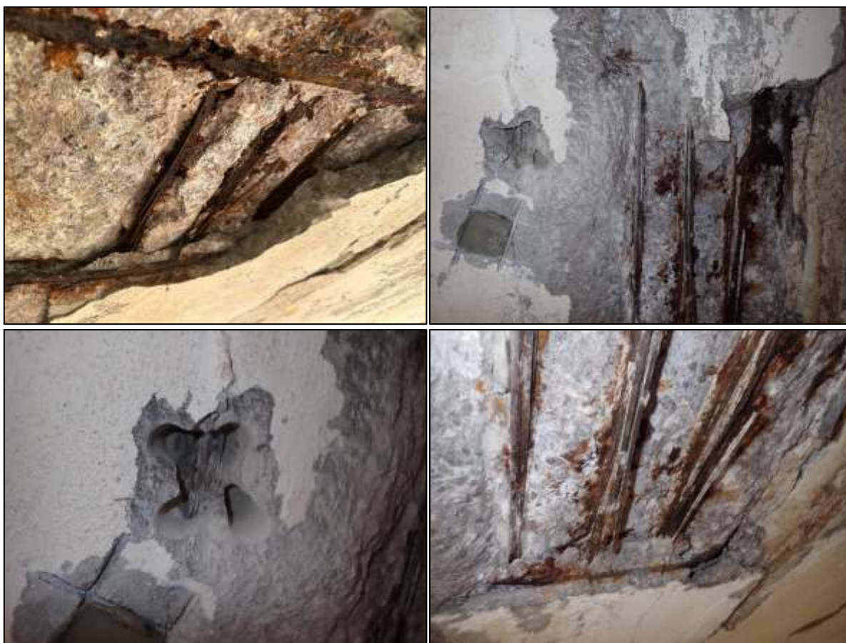
Foto 2: Detail sondy P2, předpínací výztuž, spodní líc nosníku č. 3, pole č. 3, poloha viz Příloha 1. Na předpínací výztuži byla nalezena rozsáhlá koroze. Hodnocení korozního stavu přepínací výztuže: stupeň 3 až 6. Kanálky částečně vyplněny injektážní směsí. Nesoudržná krycí vrstva betonu. Krytí předpínací výztuže cca 35-40 mm.
