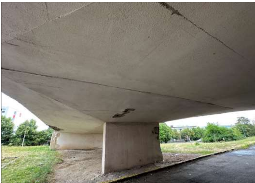
Foto 17: Monolitická část - Nájezd v oblasti dilatace, patrné stopy po zatékání a akusticky zřejmá nesoudržná krycí vrstva betonu, koroze betonářské výztuže NK
