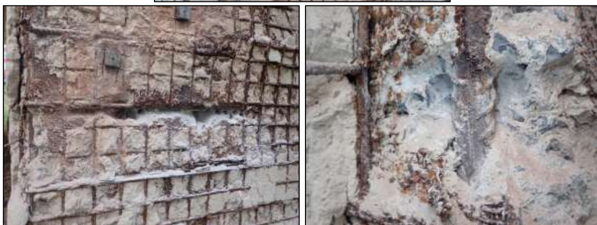
Foto 26: Detail sondy S6, prefabrikovaná část – pilíř, poloha viz Příloha 1. Svislá a vodorovná výztuž. Povrchová koroze (P) s oslabením plochy průřezu do 5 %. Nesoudržná vrstva sanace (opadává), korodující pletivo a KARI síť.
