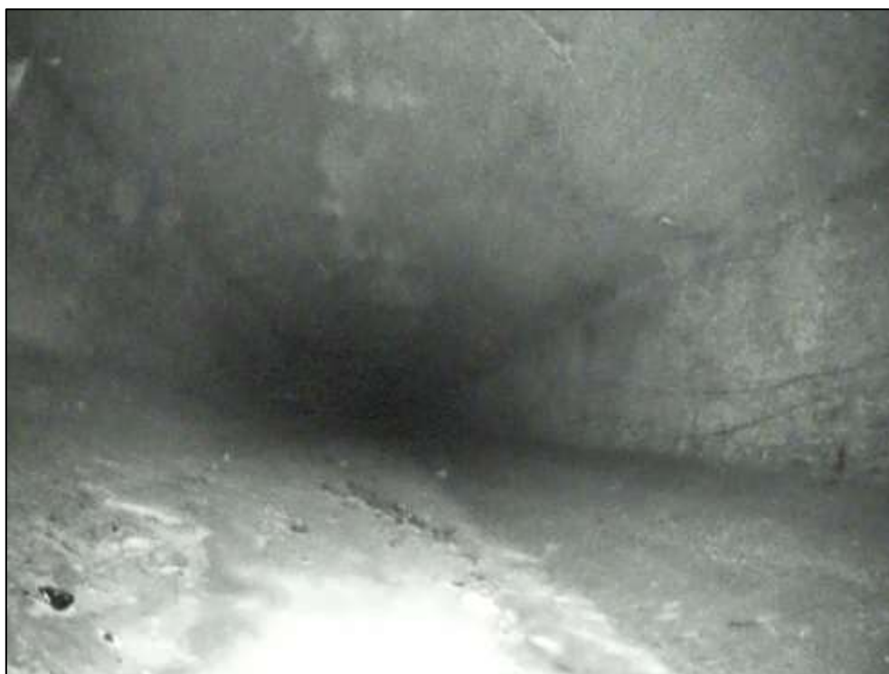
Foto 18: Detail vnitřního povrchu komory. Nosník č. 8, pole č. 2. Pohled směrem ke středu rozpětí. Neaktivní stopy po průsacích spojené s výluhy. Lokální degradace povrchu betonu. Lokální koroze měkké výztuže nosníku.
