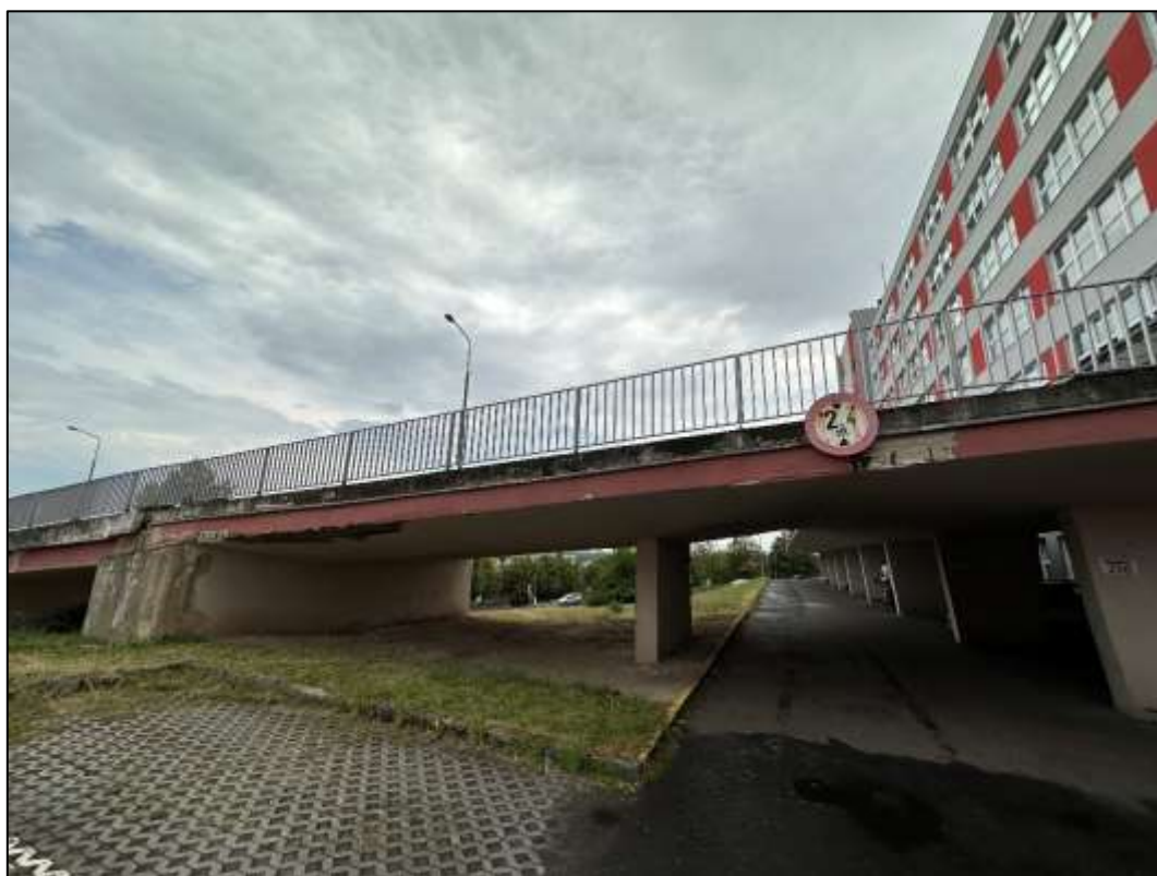
Foto 19: Monolitická část - Nájezd v oblasti dilatace, pohled zprava, patrné stopy po zatékání a degradace krycí vrstvy betonu, koroze obnažené betonářské výztuže NK
