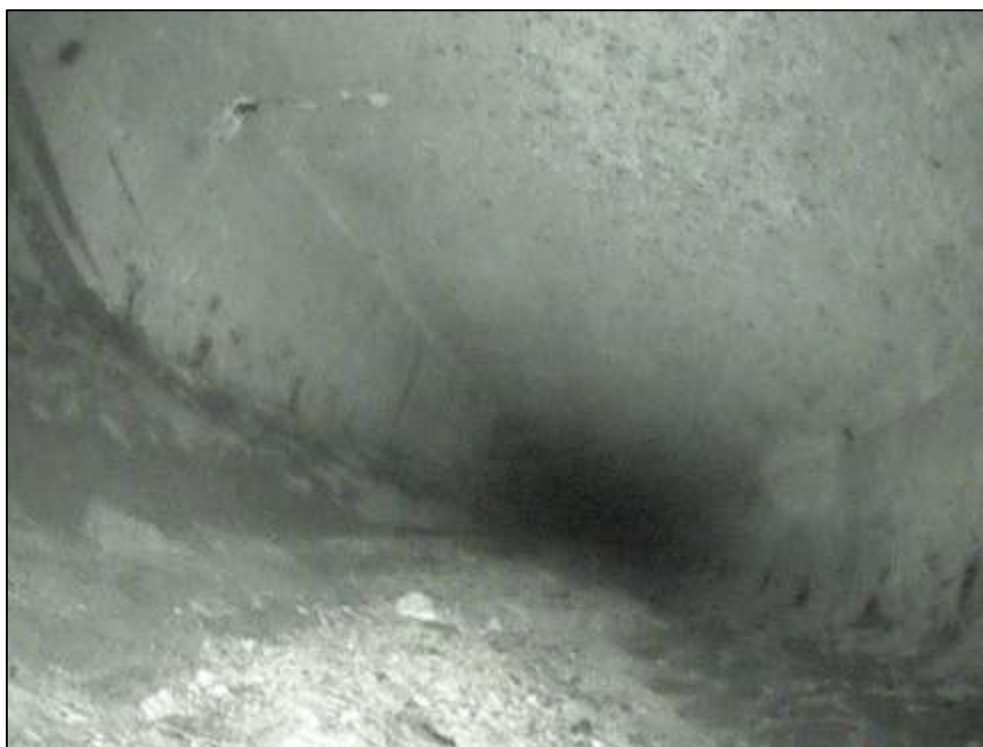
Foto 2: Detail vnitřního povrchu komory. Nosník č. 3, pole č. 3. Pohled směrem ke středu rozpětí. Neaktivní stopy po průsacích spojené s výluhy. Lokální degradace povrchu betonu. Lokální koroze měkké výztuže nosníku.
