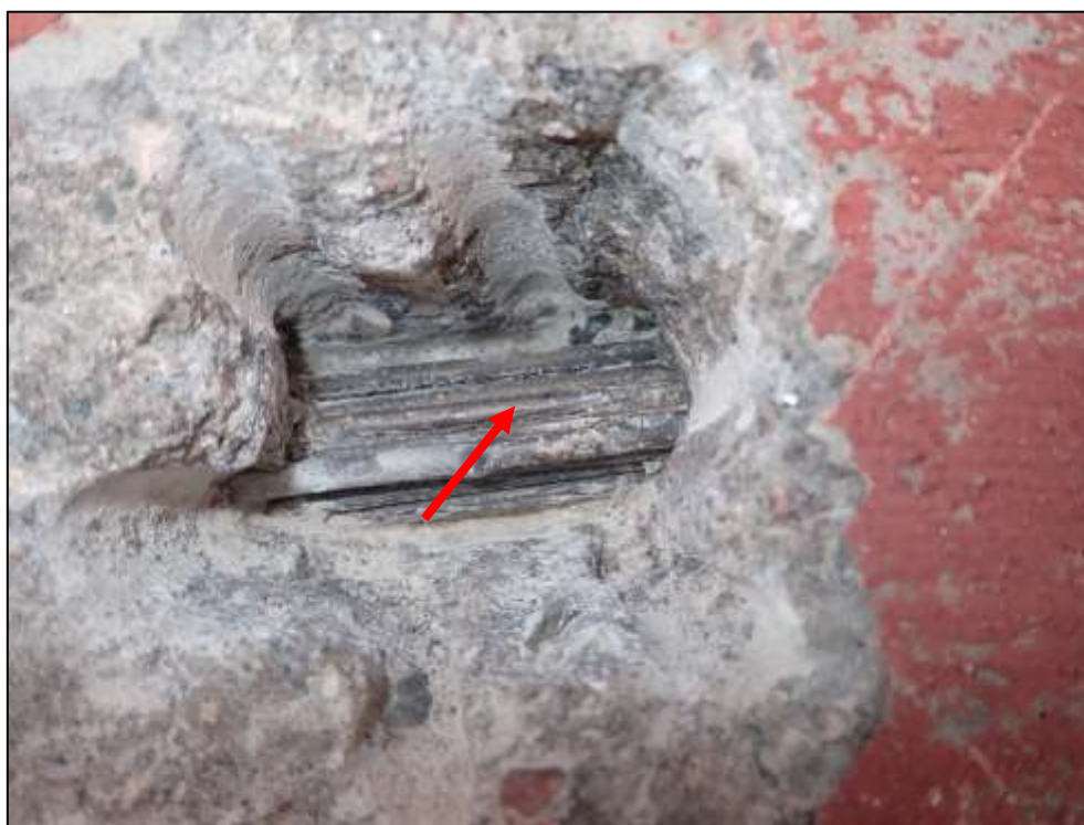
Foto 20: Detail sondy P20, předpínací výztuž, stěna nosníku č. 9, pole č. 3, poloha viz Příloha 1. Na předpínací výztuži byla nalezena korozе. Hodnocení korozního stavu předpínací výztuže: stupeň 2. Kanálek vyplněn injektážní směsí částečně. Krytí předpínací výztuže cca 35 mm.
