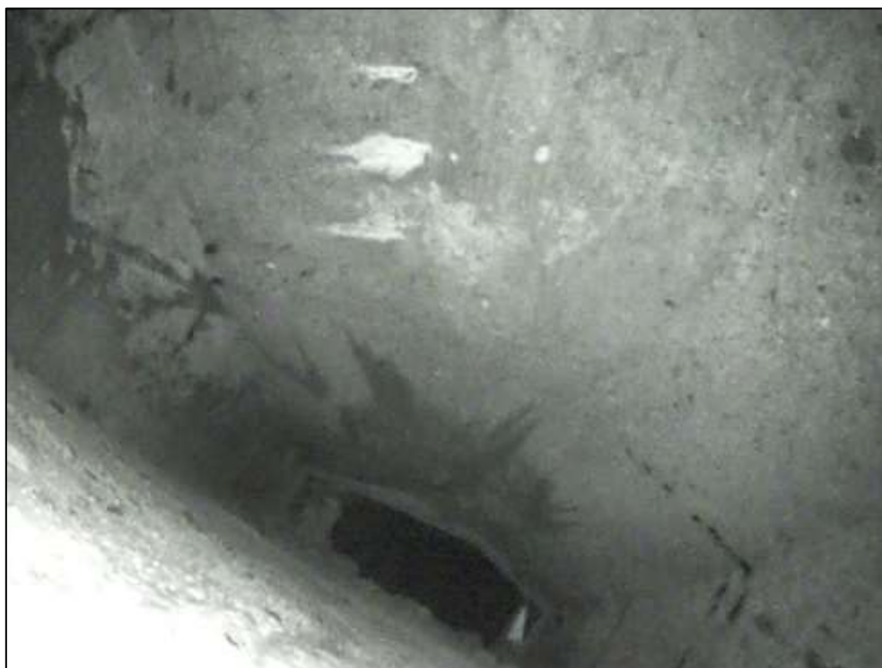
Foto 15: Detail vnitřního povrchu komory. Nosník č. 6, pole č. 2. Pohled směrem k opěře. Neaktivní stopy po průsacích spojené s výluhy. Lokální degradace povrchu betonu. Lokální koroze měkké výztuže nosníku.
