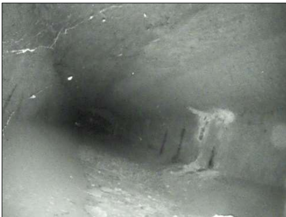
Foto 20: Detail vnitřního povrchu komory. Nosník č. 9, pole č. 2. Pohled směrem ke středu rozpětí. Neaktivní stopy po průsacích spojené s výluhy. Lokální degradace povrchu betonu. Lokální koroze měkké výztuže nosníku.
