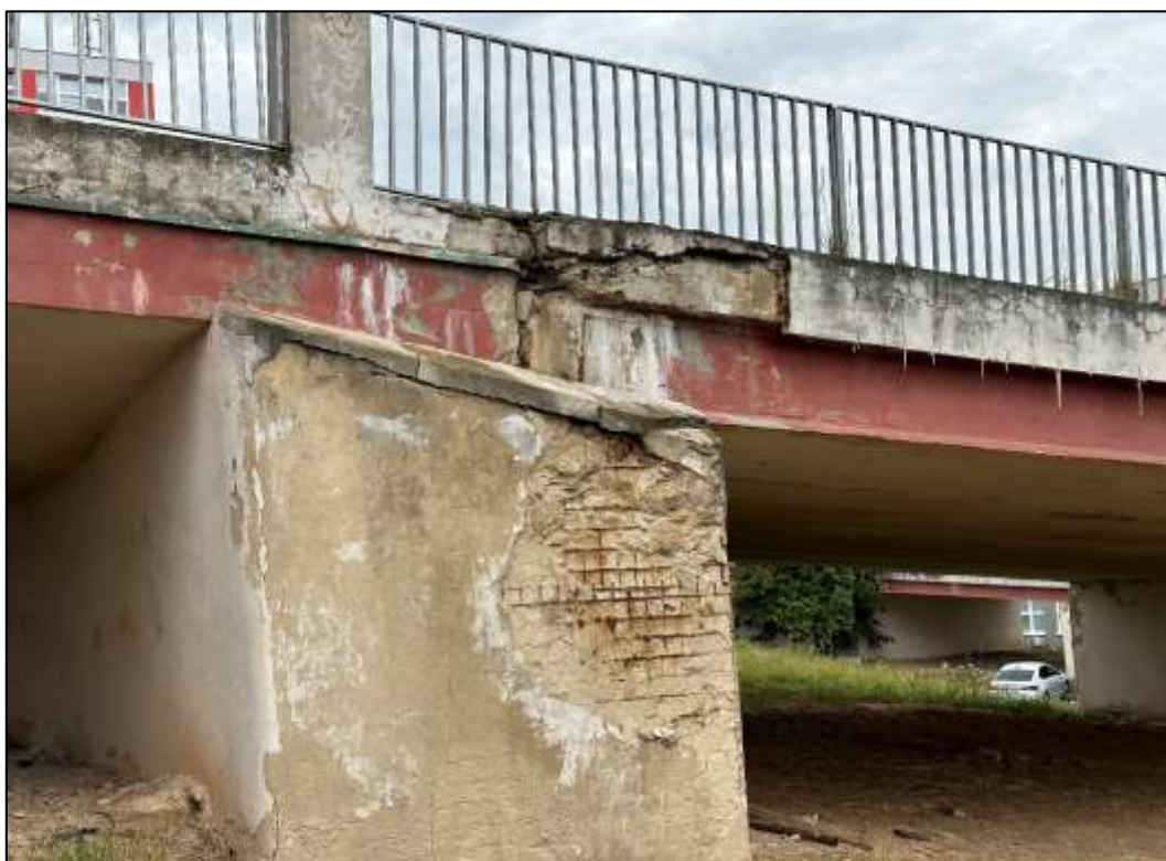
Foto 29: Prefabrikovaná část – Pilíř P4 mezi prefabrikovanou a monolitickou částí mostu, pohled zleva, patrné zatékání na konstrukci a degradace krycí vrstvy betonu s korozí obnažené výztuže
