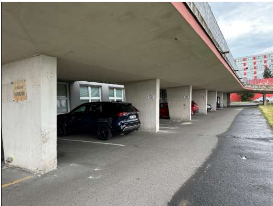
Foto 5: Monolitická část - Pohled na pilíře, odprýsknutá krycí vrstva betonu v patě pilířů, koroze lokálně obnažené výztuže
