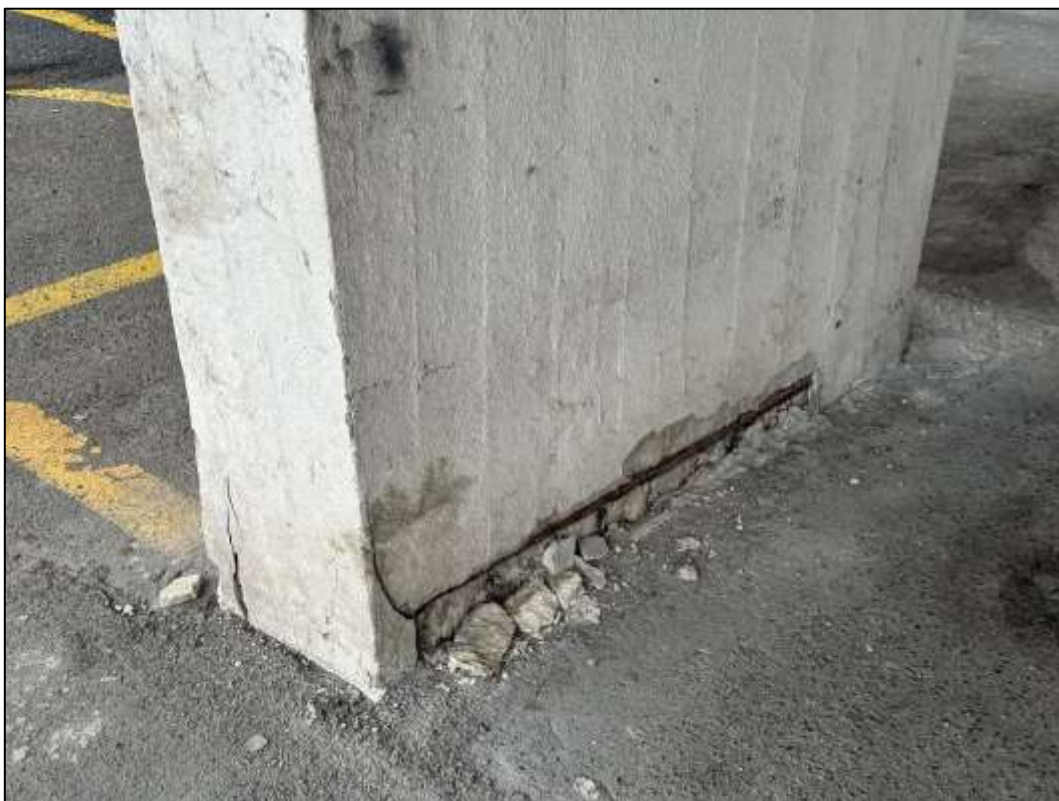
Foto 6: Monolitická část - Pohled na pilíře, odprýsknutá krycí vrstva betonu v patě pilířů, koroze lokálně obnažené výztuže
