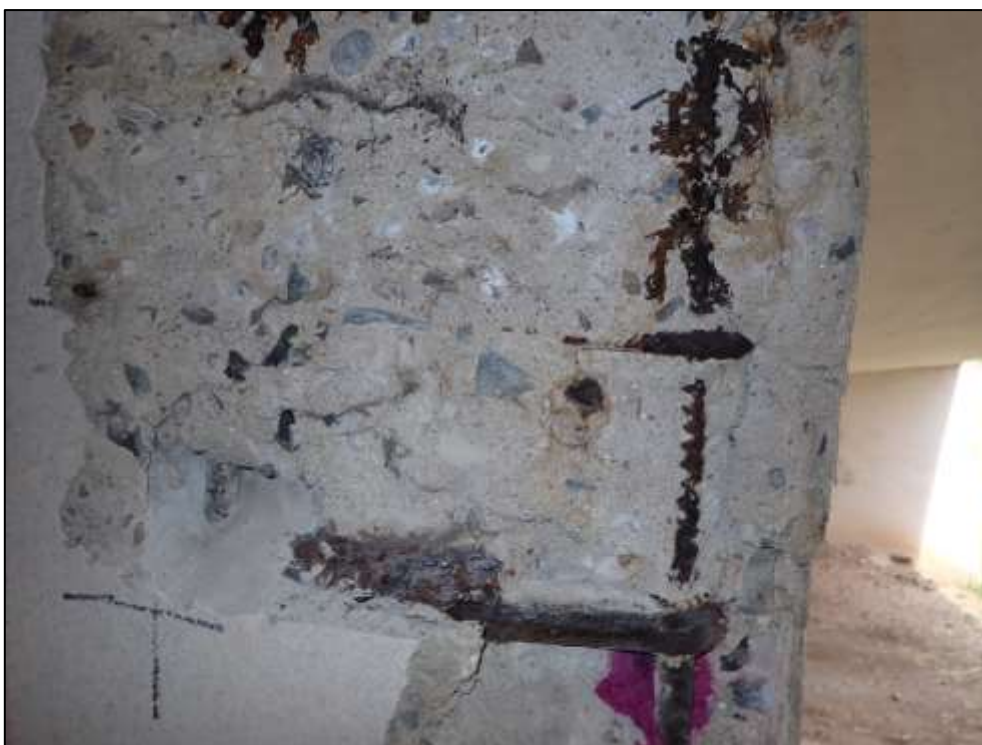
Foto 24: Detail sondy S4, monolitická část – pilíř, poloha viz Příloha 1. Svislá a vodorovná výztuž. Hlubková koroze (H) s oslabením plochy průřezu do 15 %.
