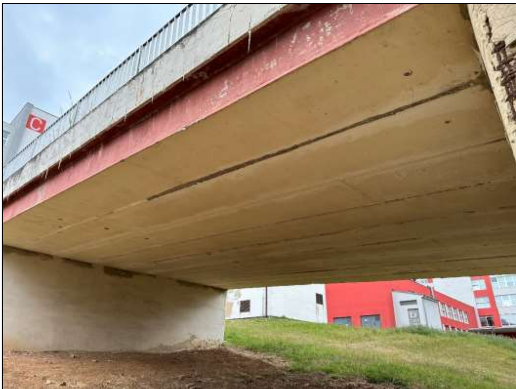
Foto 40: Prefabrikovaná část – Pole 2, pohled zleva na spodní líc NK, lokální stopy po zatékání mezi jednotlivé nosníky a stékání vody po římse
