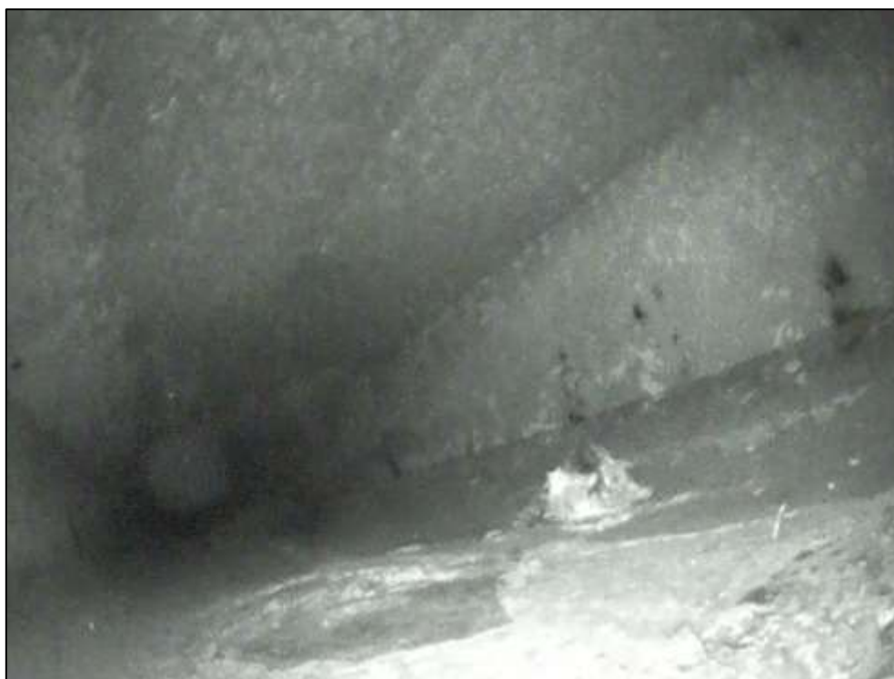
Foto 10: Detail vnitřního povrchu komory. Nosník č. 9, pole č. 3. Pohled směrem ke středu rozpětí. Neaktivní stopy po průsacích spojené s výluhy. Lokální degradace povrchu betonu. Lokální koroze měkké výztuže nosníku.
