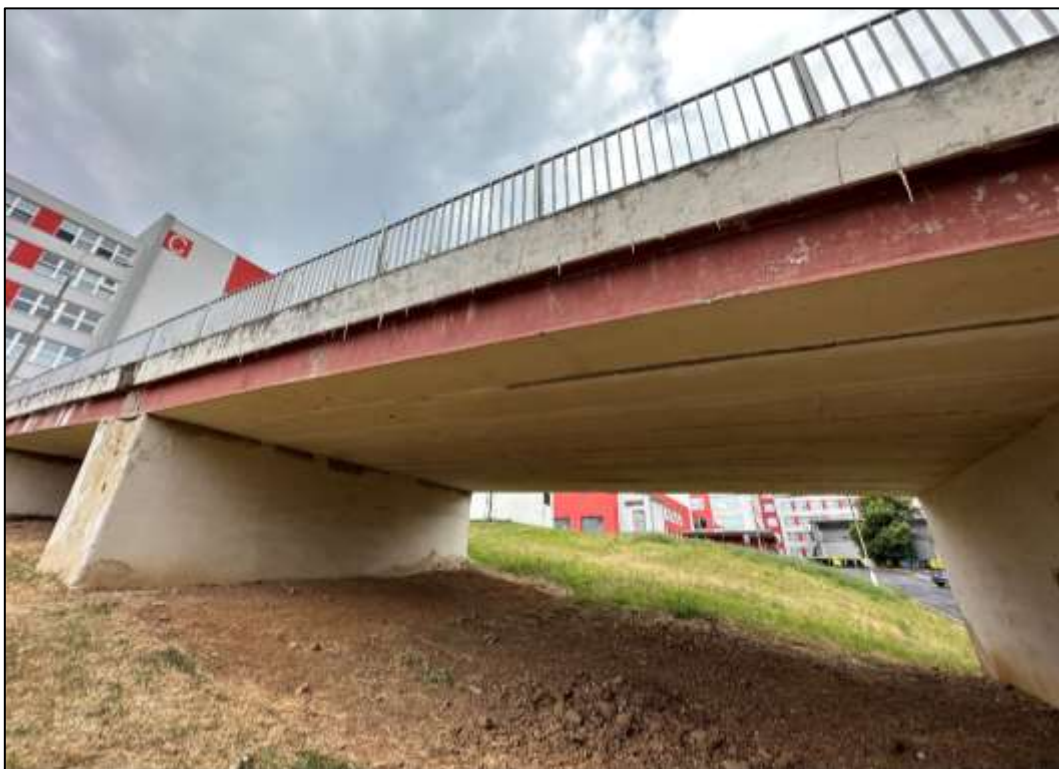
Foto 39: Prefabrikovaná část – Pole 2, pohled zleva, lokální stopy po zatékání mezi jednotlivé nosníky a stékání vody po římse
