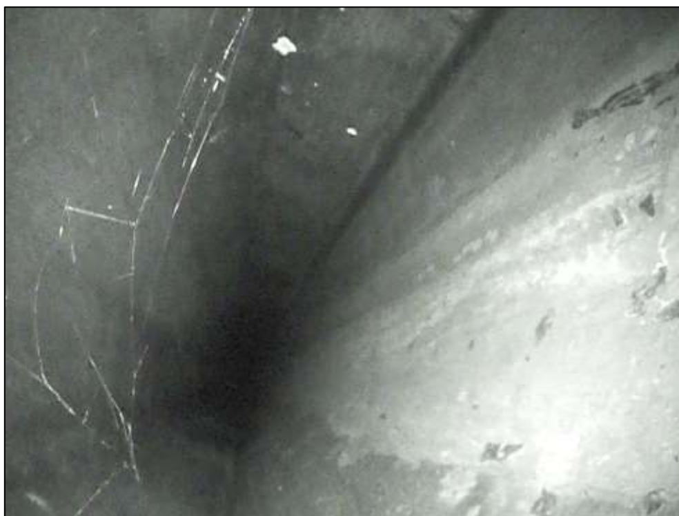
Foto 14: Detail vnitřního povrchu komory. Nosník č. 2, pole č. 2. Pohled směrem ke středu rozpětí. Neaktivní stopy po průsacích spojené s výluhy. Lokální degradace povrchu betonu. Lokální koroze měkké výztuže nosníku.
