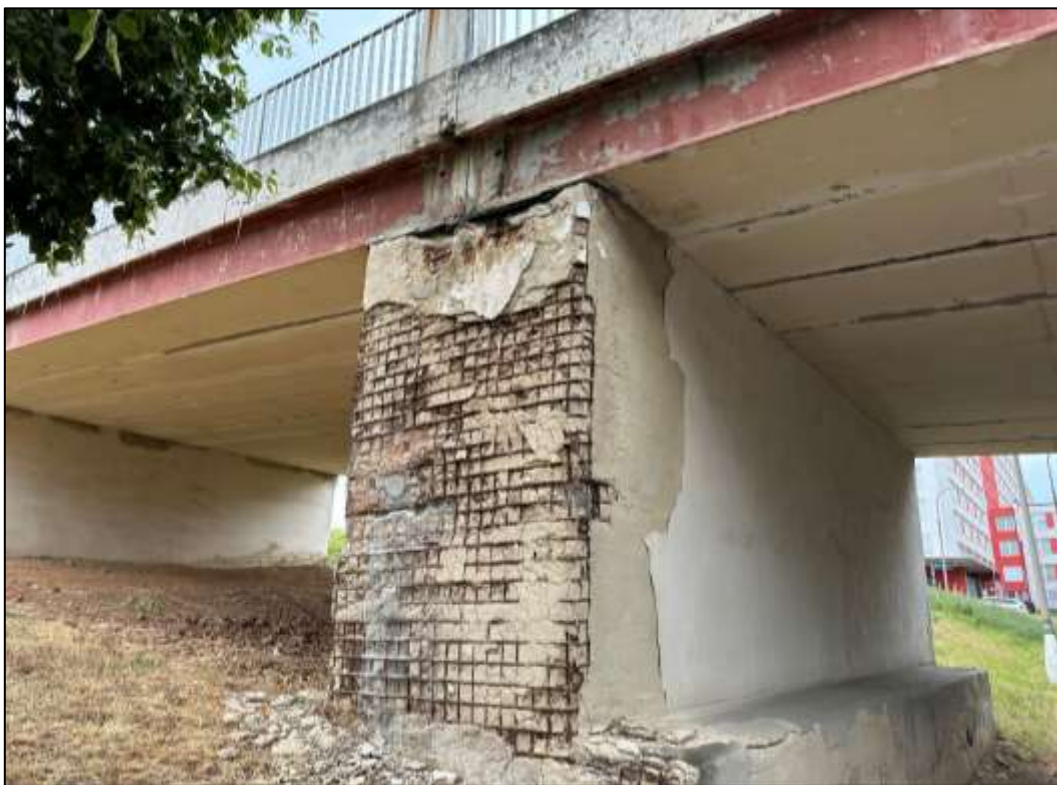
Foto 33: Prefabrikovaná část – Pilíř P2 mezi polem 1 a 2, pohled zleva, patrné zatékání na konstrukci a degradace krycí vrstvy betonu s korozi obnažené výztuže, v tomto případě i hlavní výztuže pilíře, nejen dodatečných sítí zesílení
