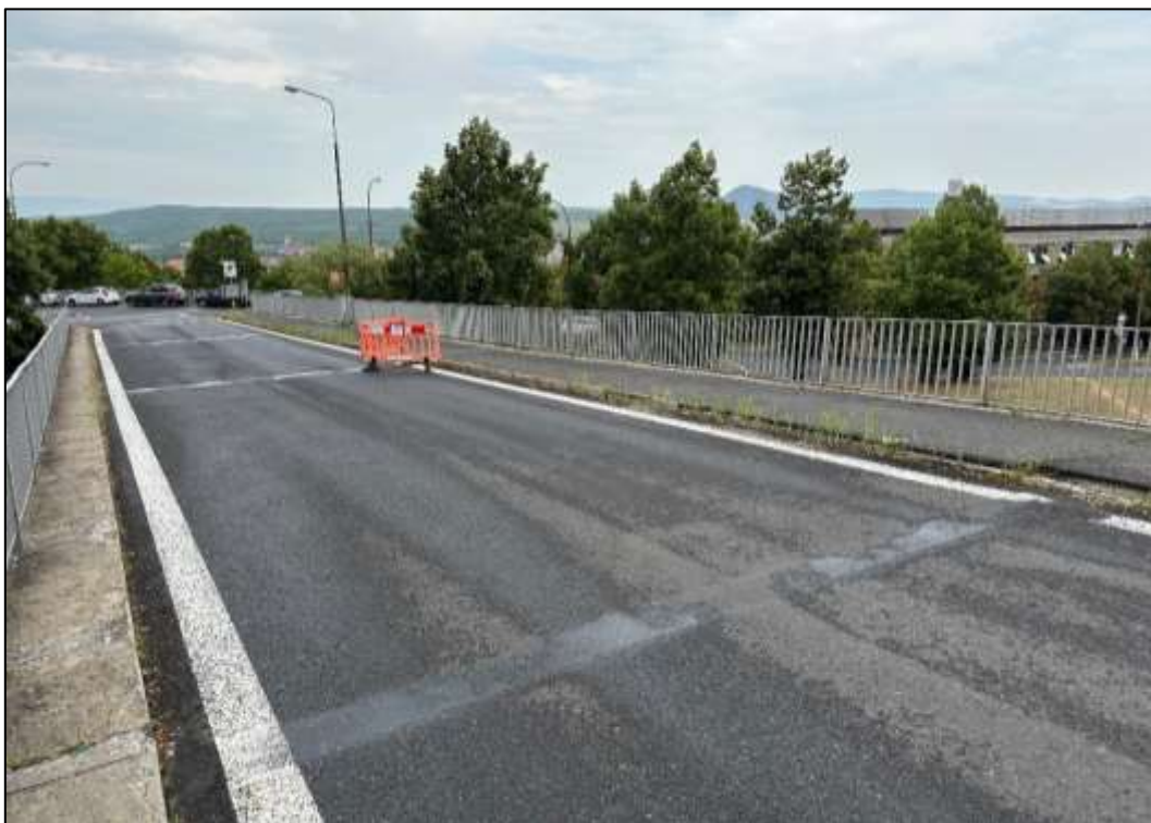
Foto 47: Prefabrikovaná část – Pohled na mostní svršek, patrná náletová vegetace v oblasti obrubníku a říms, dále prorůstají dilatační spáry v chodníku, degradující, místy chybějící, části obrubníku
