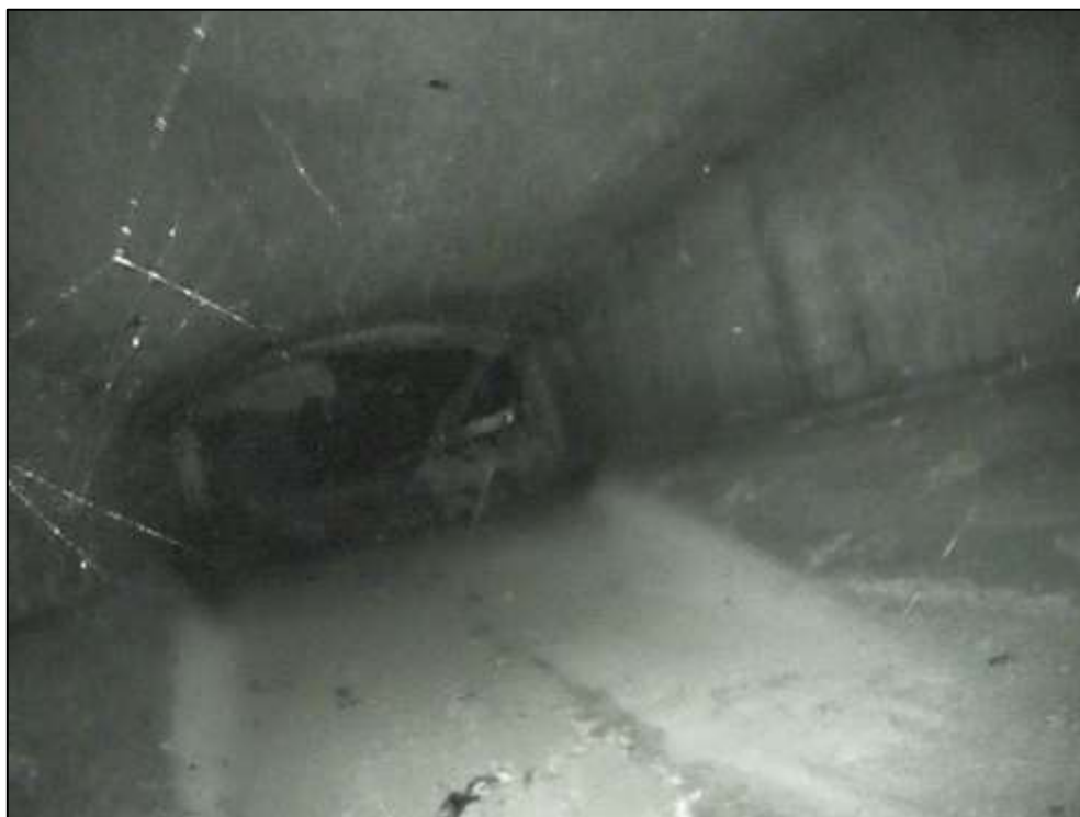
Foto 13: Detail vnitřního povrchu komory. Nosník č. 2, pole č. 2. Pohled směrem k opěře. Neaktivní stopy po průsacích spojené s výluhy. Lokální degradace povrchu betonu. Lokální koroze měkké výztuže nosníku.
