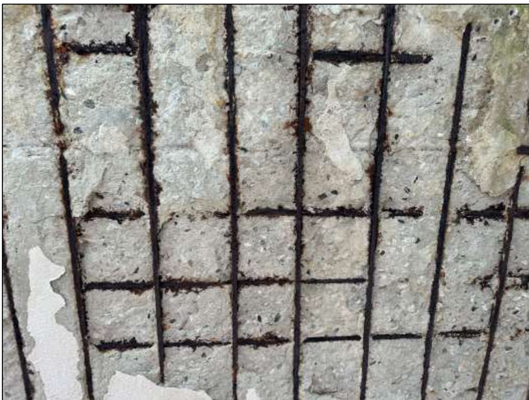
Foto 13: Monolitická část - Vykonzolovaná deska podél budovy, patrné stopy po zatékání a plošná degradace krycí vrstvy betonu, koroze obnažené betonářské výztuže NK
