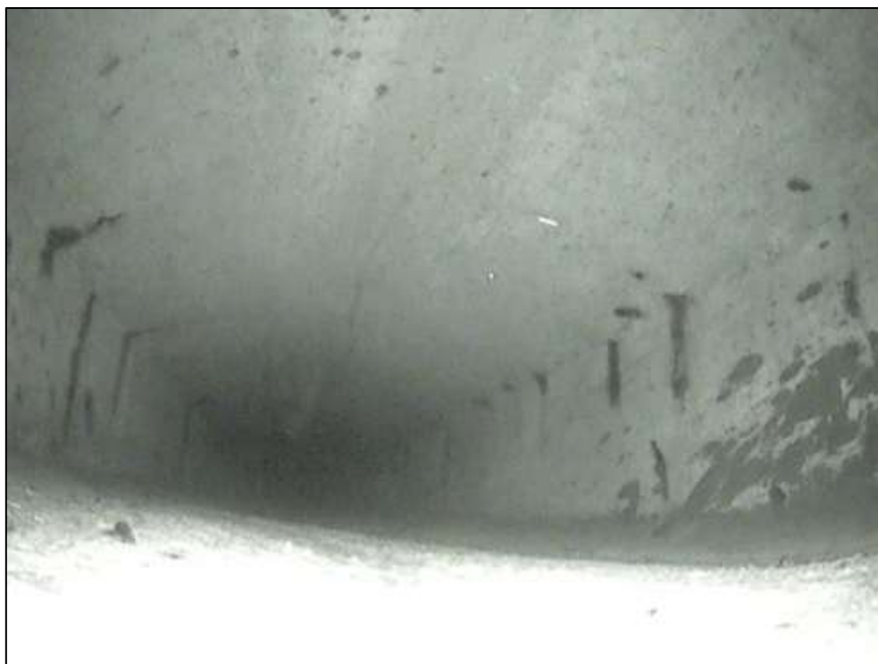
Foto 16: Detail vnitřního povrchu komory. Nosník č. 6, pole č. 2. Pohled směrem ke středu rozpětí. Neaktivní stopy po průsacích spojené s výluhy. Lokální degradace povrchu betonu. Lokální koroze měkké výztuže nosníku.
