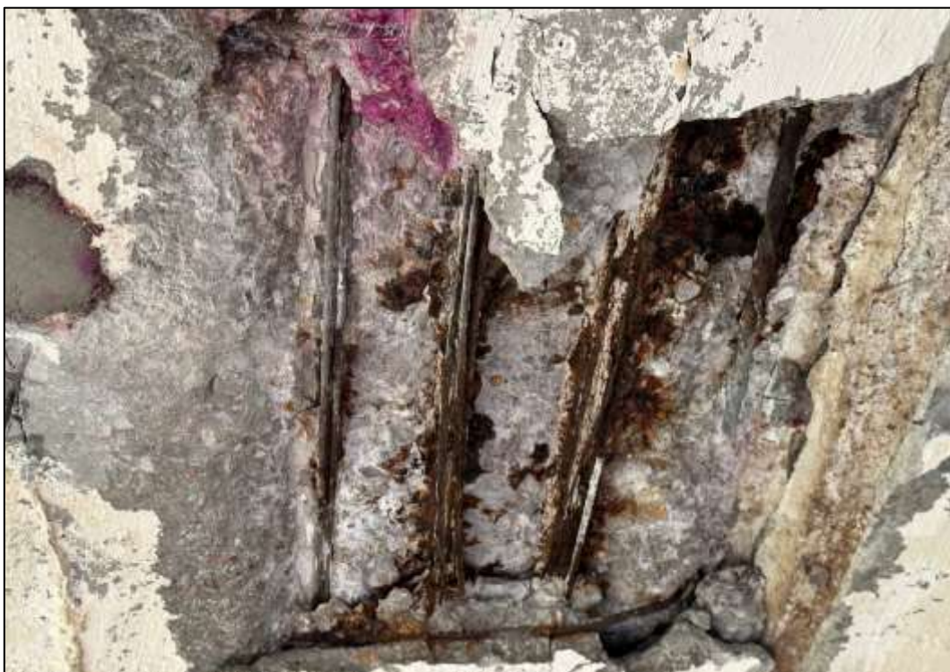
Foto 44: Prefabrikovaná část – Pole 3, na nosnících č. 3 a 4 jsou značné stopy po zatékání a ve velké míře je poškozena krycí vrstva betonu a předpínací výztuž při spodním lící obou nosníků. Jedná se o několik lan, která jsou zcela překorodována
