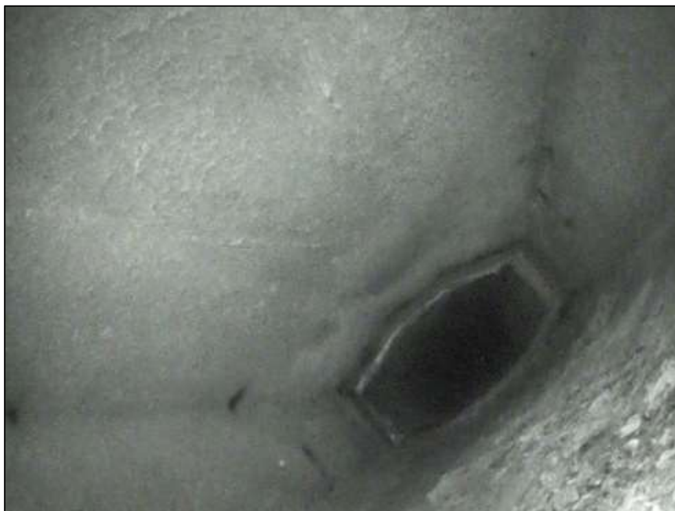
Foto 9: Detail vnitřního povrchu komory. Nosník č. 9, pole č. 3. Pohled směrem k opěře. Neaktivní stopy po průsacích spojené s výluhy. Lokální degradace povrchu betonu. Lokální koroze měkké výztuže nosníku.
