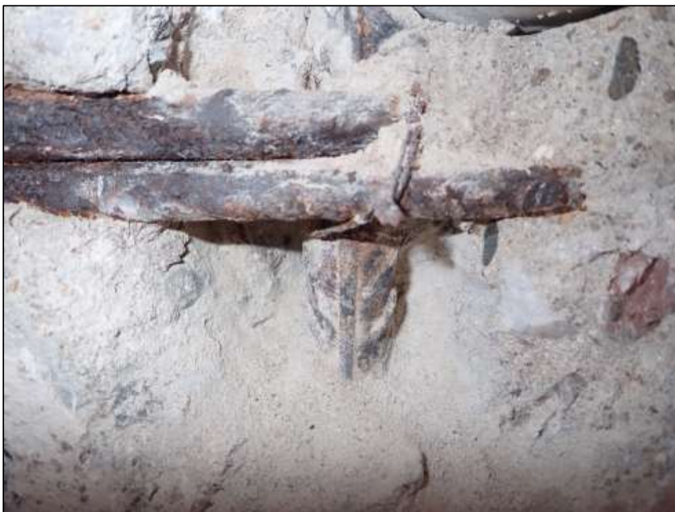
Foto 23: Detail sondy S3, monolitická část – pilíř, poloha viz Příloha 1. Svislá a vodorovná výztuž. Povrchová koroze (P) bez oslabení plochy průřezu.
