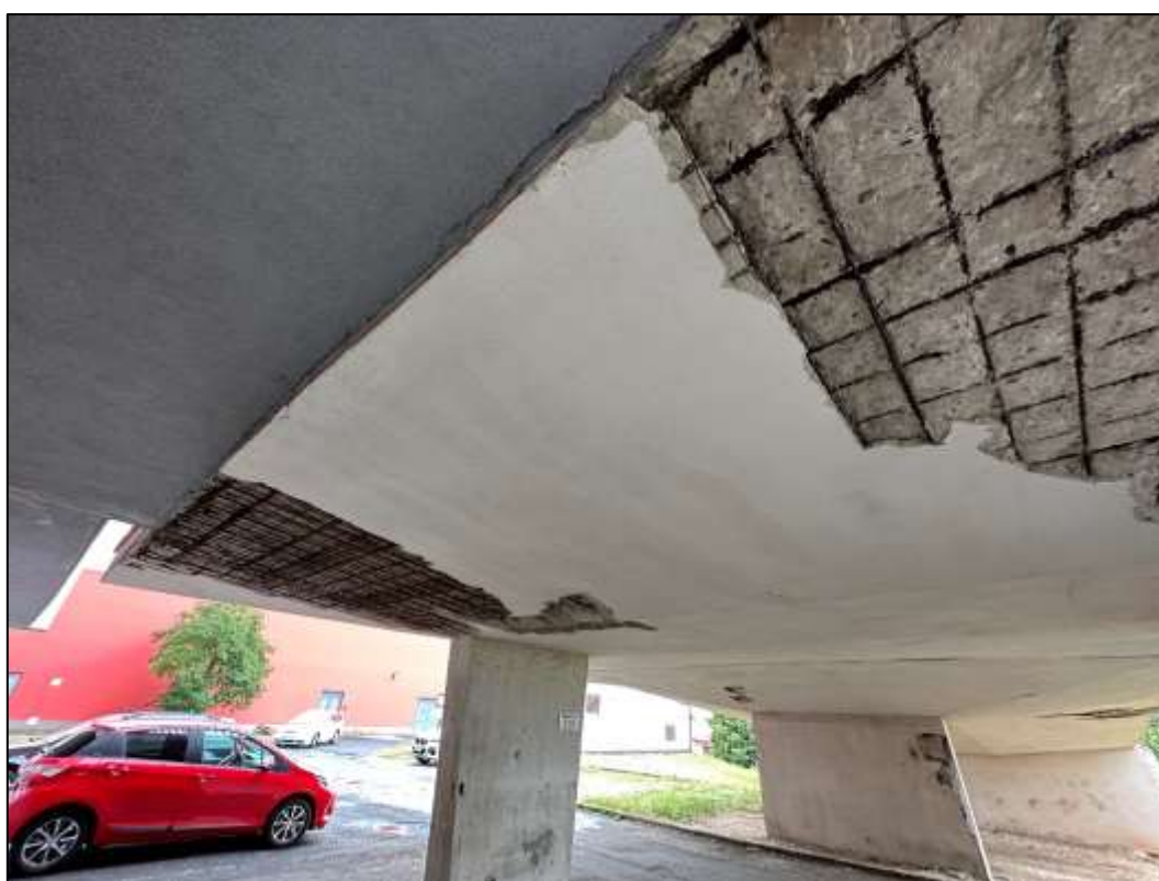
Foto 16: Monolitická část - Vykonzolovaná deska na začátku nájezdu u budovy, patrné stopy po zatékání a plošná degradace krycí vrstvy betonu – částečně již opadaná, koroze obnažené betonářské výztuže NK, nesoudržná vrstva dodatečně provedené sanace s přidanou KARI sítí
