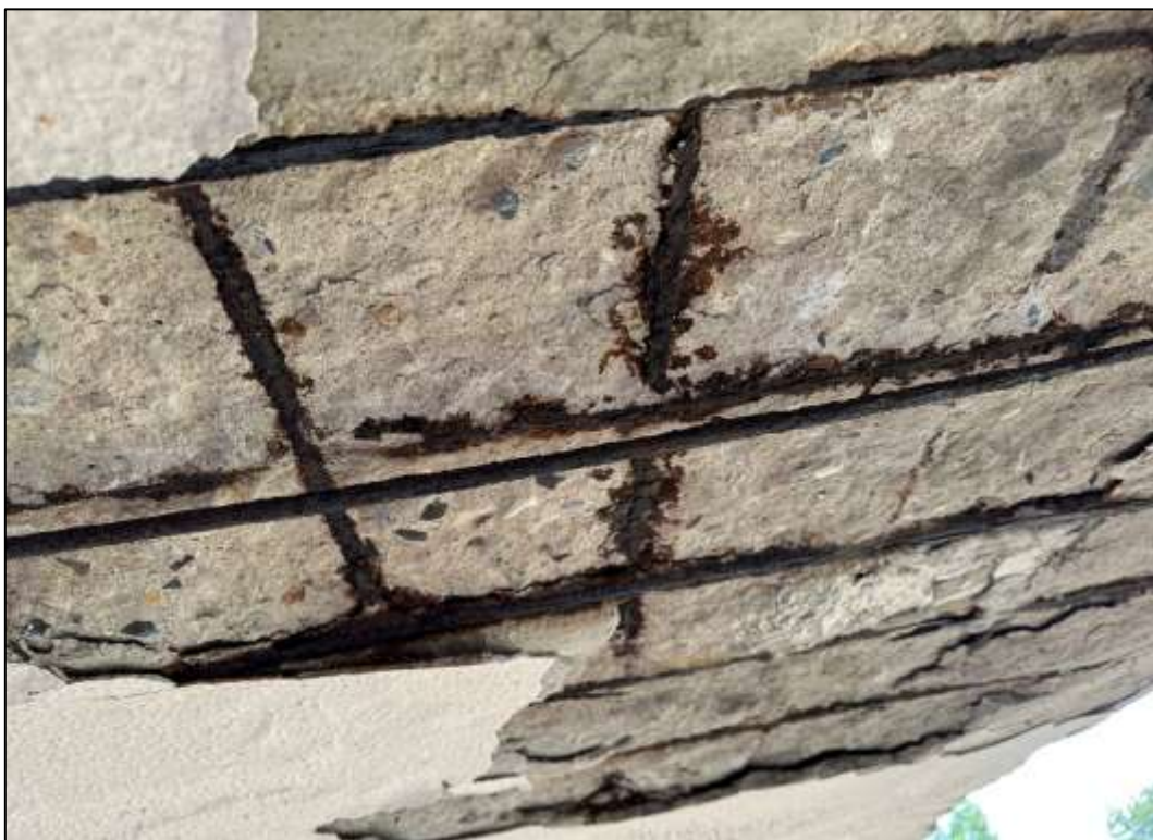
Foto 25: Monolitická část – Nájezd v oblasti dilatace, degradace krycí vrstvy betonu – částečně již opadaná, rozsáhlá koroze obnažené betonářské výztuže NK
