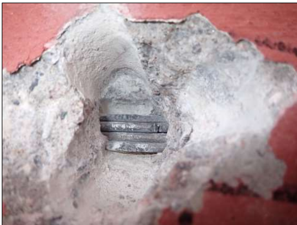
Foto 6: Detail sondy P6, předpínací výztuž, stěna nosníku č. 9, pole č. 3, poloha viz Příloha 1. Na předpínací výztuži nebyla nalezena koroze. Hodnocení korozního stavu předpínací výztuže: stupeň 1. Kanálek zcela vyplněn injektážní směsí. Krytí předpínací výztuže cca 45 mm.
