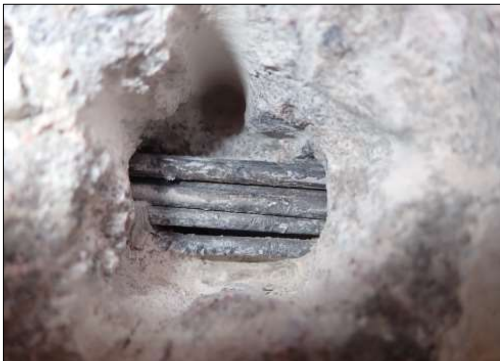
Foto 19: Detail sondy P19, předpínací výztuž, stěna nosníku č. 1, pole č. 3, poloha viz Příloha 1. Na předpínací výztuži byla nalezena korozе. Hodnocení korozního stavu předpínací výztuže: stupeň 2. Kanálek vyplněn injektážní směsí částečně. Krytí předpínací výztuže cca 35 mm.
