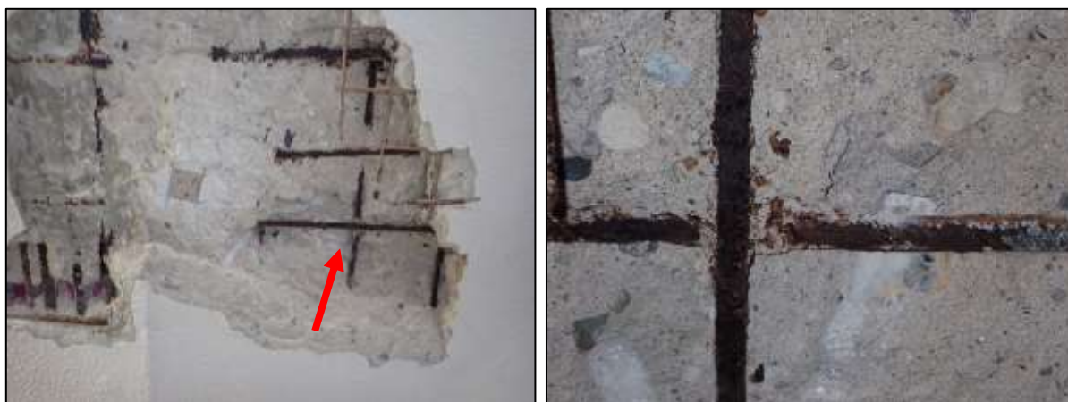
Foto 30: Detail sondy S10, monolitická část – konzola desky (spodní líc), poloha viz Příloha 1. Příčná a podélná výztuž. Povrchová koroze (P) s oslabením plochy průřezu do 5 %. Nesoudržná krycí vrstva betonu, částečně opadané, koroze obnažené výztuže.
