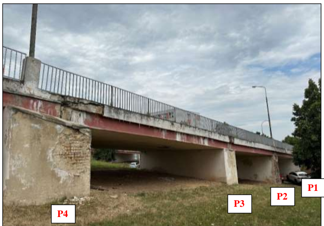
Foto 27: Prefabrikovaná část – Pole 1 až 3, pohled zleva, plošně patrné zatékání na konstrukci a degradace krycí vrstvy betonu – částečně již opadaná, rozsáhlá korozie obnažené betonářské výztuže zejména dodatečné výztuže zesílených pilířů
