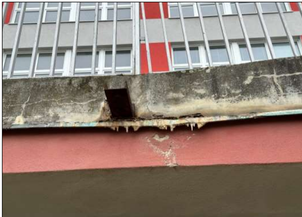
Foto 26: Monolitická část – Typický pohled na odvodnění vozovky, patrné stopy po zatékání na nosnou konstrukci v okolí původních odvodňovačů
