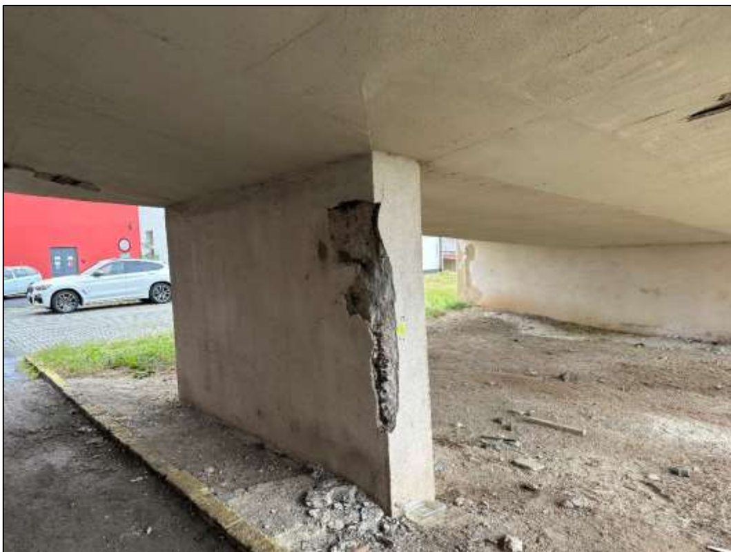
Foto 9: Monolitická část - Pohled na pilíř u dilatace rampy, po výšce pilíře patrné porušení rohů, koroze obnažené výztuže
