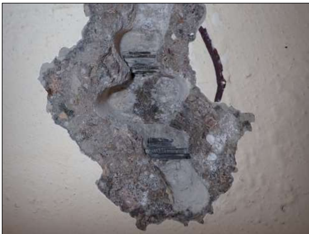
Foto 17: Detail sondy P17, předpínací výztuž, spodní líc nosníku č. 7, pole č. 1, poloha viz Příloha 1. Na předpínací výztuži byla nalezena korozе. Hodnocení korozního stavu předpínací výztuže: stupeň 2. Kanálek zcela vyplněn injektážní směsí. Krytí předpínací výztuže cca 40 mm.
