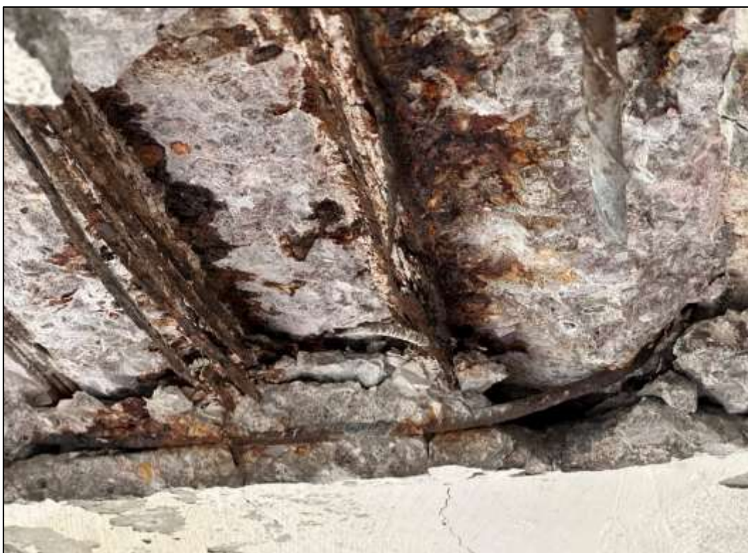
Foto 46: Prefabrikovaná část – Pole 3, na nosnících č. 3 a 4 jsou značné stopy po zatékání a ve velké míře je poškozena krycí vrstva betonu a předpínací výztuž při spodním lici obou nosníků. Jedná se o několik lan, která jsou zcela překorodována
