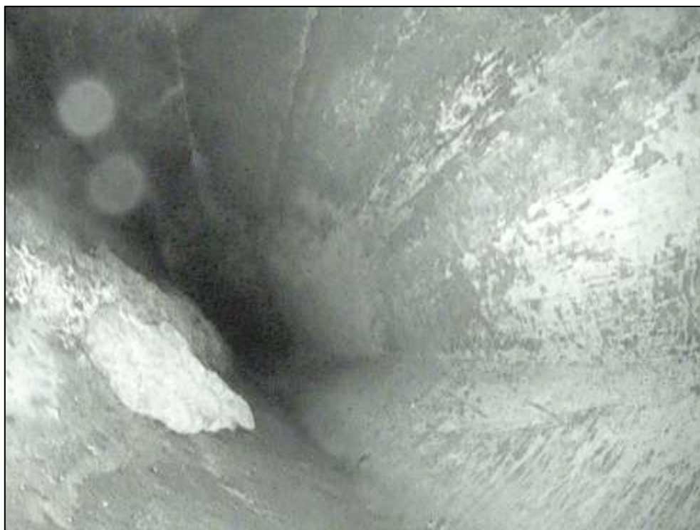
Foto 6: Detail vnitřního povrchu komory. Nosník č. 5, pole č. 3. Pohled směrem ke středu rozpětí. Neaktivní stopy po průsacích spojené s výluhy. Lokální degradace povrchu betonu. Lokální koroze měkké výztuže nosníku.
