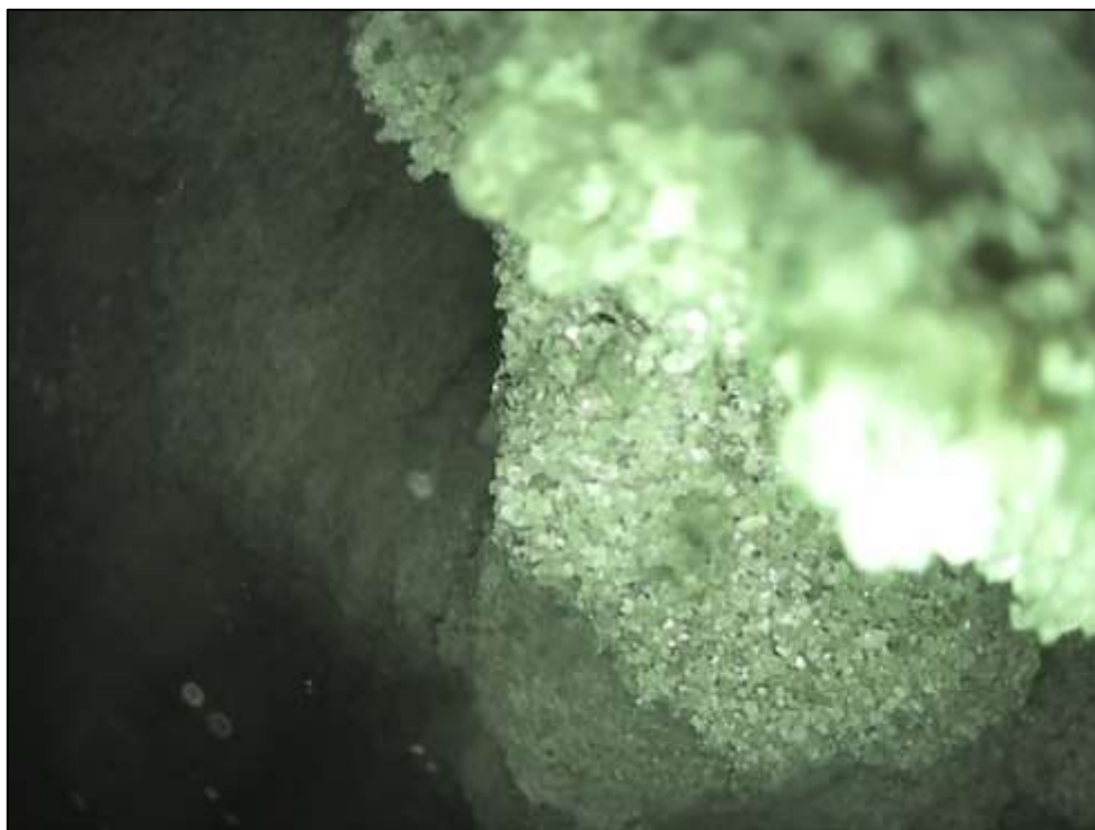
Foto 23: Detail vnitřního povrchu komory. Nosník č. 8, pole č. 1. Pohled směrem k opěře. S ohledem na poměrně značný podélný sklon nosníků je oblast v okolí odvodňovacího otvoru zanesena patrně nečistotami a stavebním materiálem.
