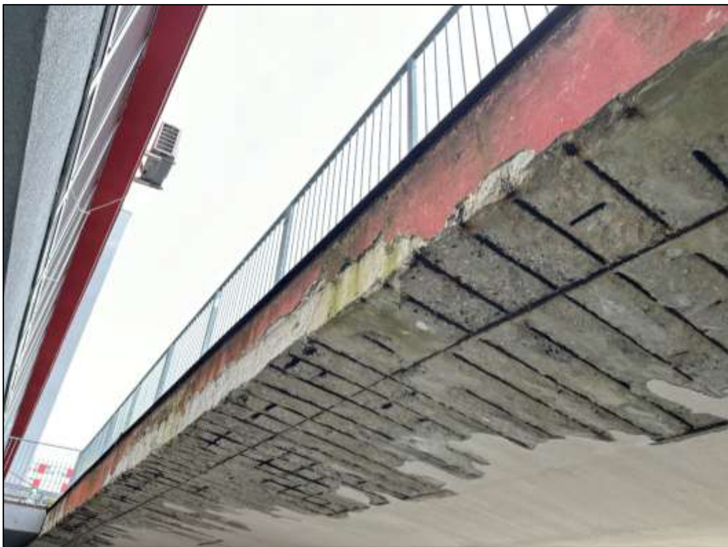
Foto 12: Monolitická část - Vykonzolovaná deska podél budovy, patrné stopy po zatékání a plošná degradace krycí vrstvy betonu – částečně již opadaná, koroze obnažené betonářské výztuže NK
