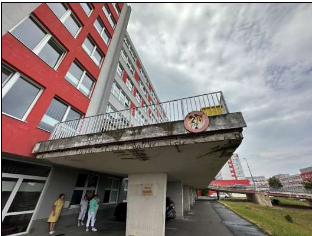
Foto 3: Monolitická část - Vykonzolovaná deska na konci nájezdu, patrné stopy po zatékání a degradace krycí vrstvy betonu, koroze obnažené betonářské výztuže NK
