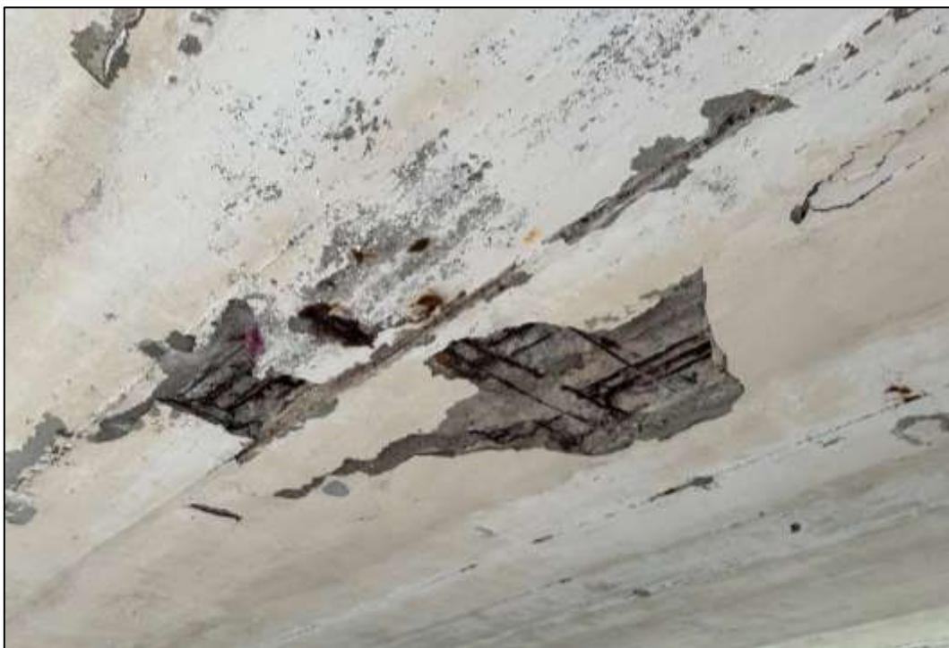
Foto 43: Prefabrikovaná část – Pole 3, pohled zleva na spodní líc NK, lokální stopy po zatékání mezi jednotlivé nosníky, zejména na nosnících č. 3 a 4 jsou značné stopy po zatékání a ve velké míře je poškozena krycí vrstva betonu a předpínací výztuž při spodním lící obou nosníků. Jedná se o několik lan, která jsou zcela překorodována
