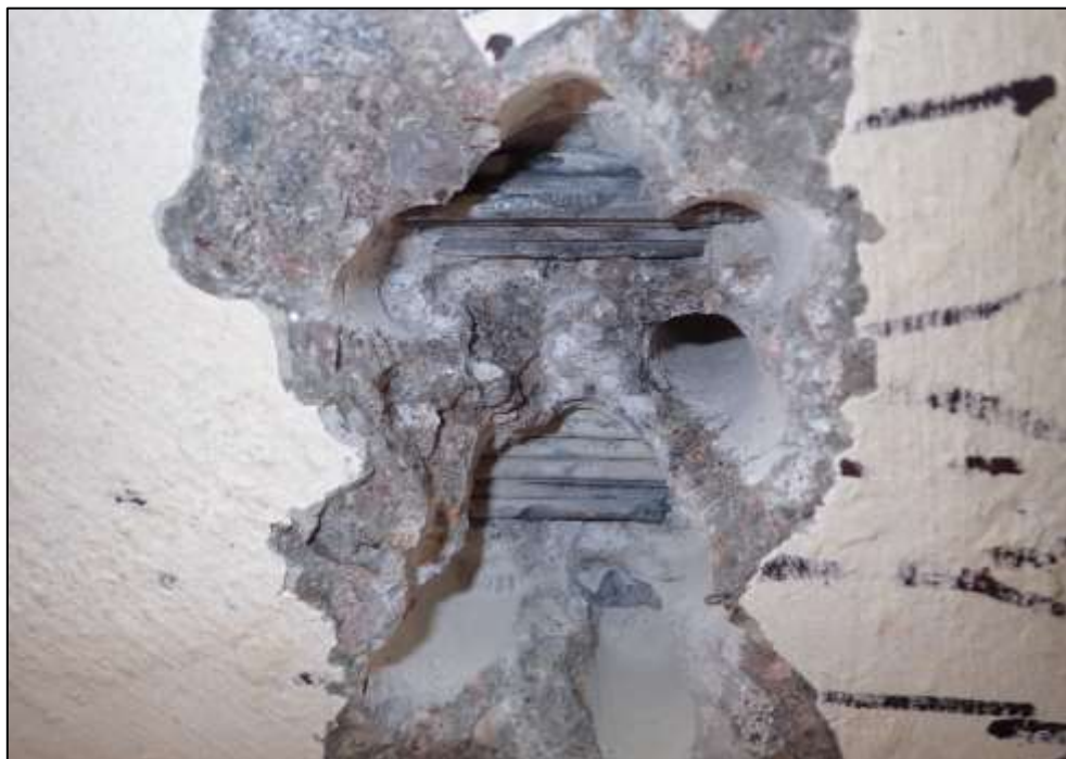
Foto 10: Detail sondy P10, předpínací výztuž, spodní líc nosníku č. 6, pole č. 2, poloha viz Příloha 1. Na předpínací výztuži byla nalezena korozie. Hodnocení korozního stavu předpínací výztuže: stupeň 2. Kanálek zcela vyplněn injektážní směsí. Krytí předpínací výztuže cca 55 a 35 mm.
