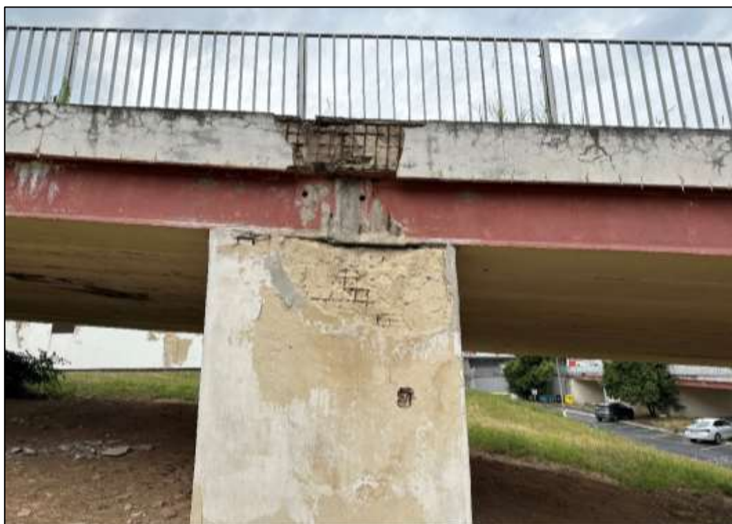
Foto 31: Prefabrikovaná část – Pilíř P3 mezi polem 2 a 3, pohled zleva, patrné zatékání na konstrukci a degradace krycí vrstvy betonu s korozi obnažené výztuže
