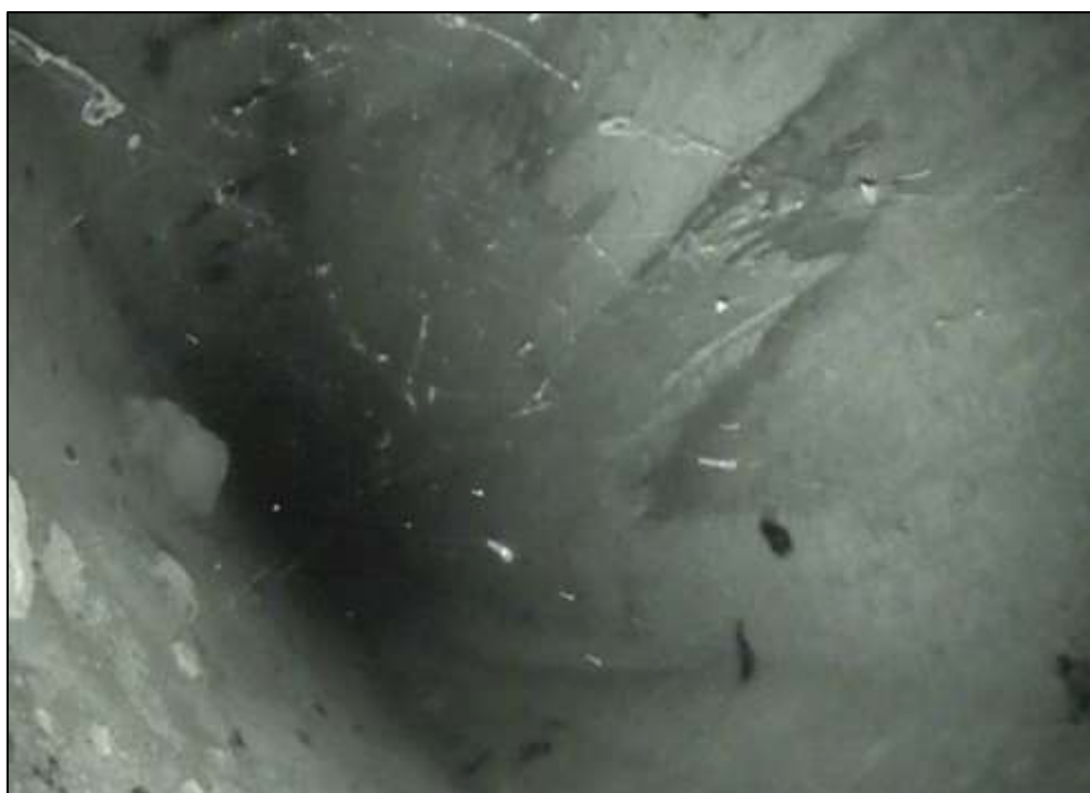
Foto 28: Detail vnitřního povrchu komory. Nosník č. 2, pole č. 1. Pohled směrem ke středu rozpětí. S ohledem na poměrně značný podélný sklon nosníků je oblast v okolí odvodňovacího otvoru zanesena patrně nečistotami a stavebním materiálem. Neaktivní stopy po průsacích spojené s výluhy. Lokální degradace povrchu betonu.
