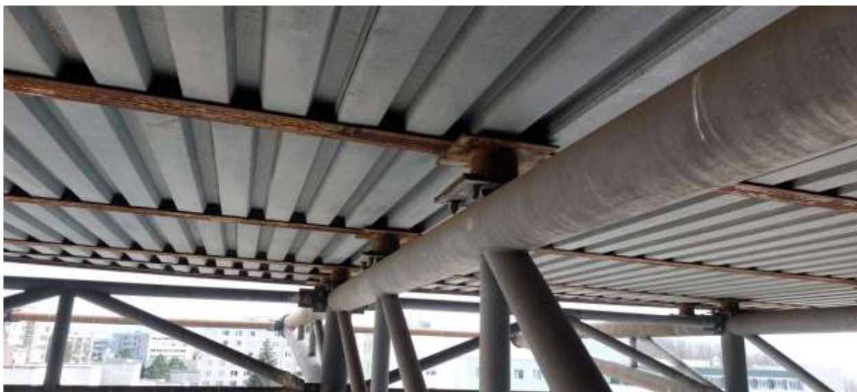
Obr. 19: Zabetonované 2xUPE (CSN) 160, spodní příruba je značně zkorodovaná včetně distančních trubek 152x8 které vytvářejí sklon plechobetonové desky heliportu
