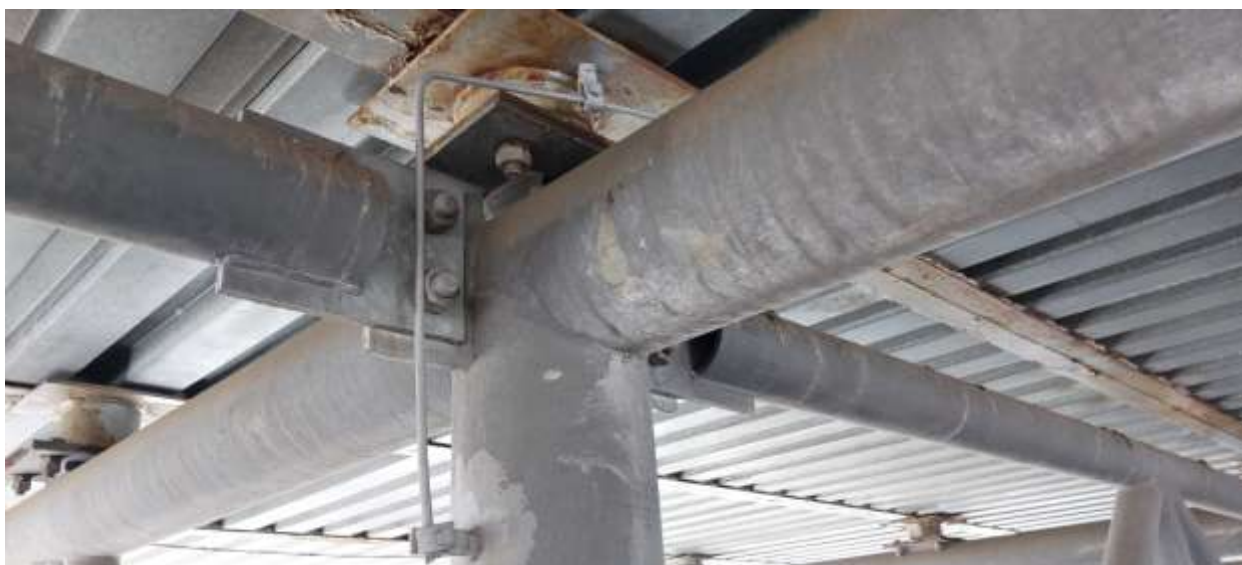
Obr. 16: Detail přírubového šroubovaného styku 2 x M 24 (8.8) u horního styku příhradového zavětrování a distance
