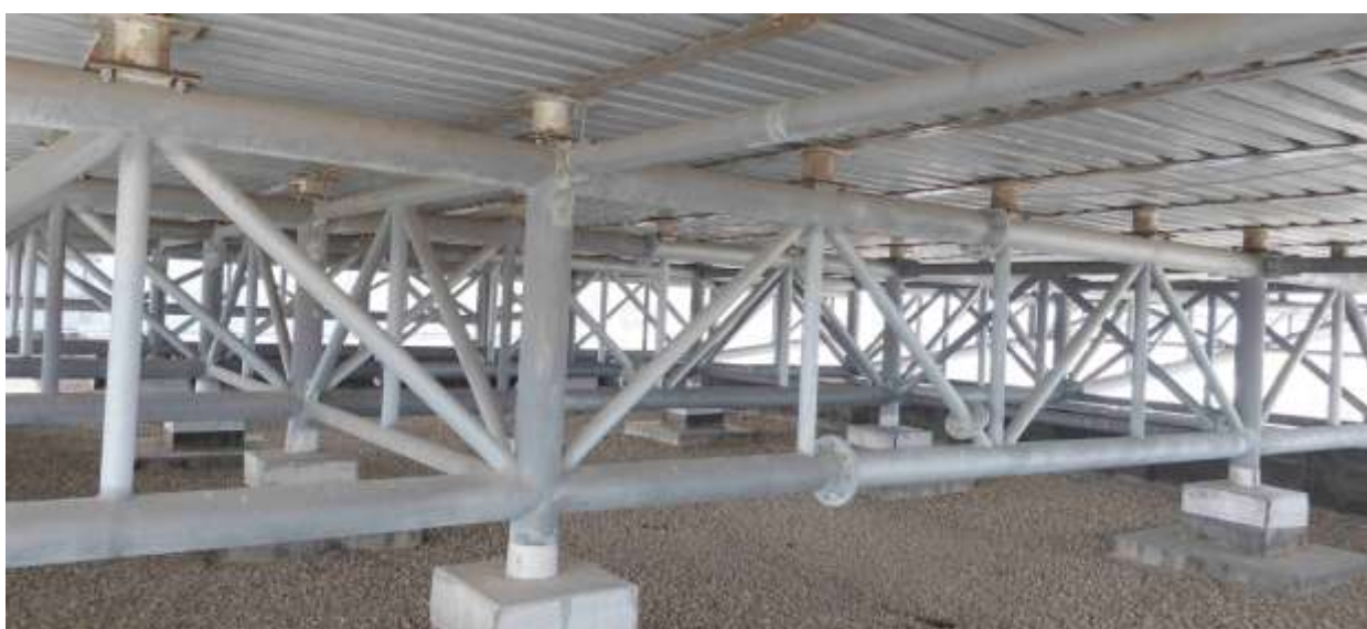
Obr. 4: Ocelová konstrukce vazníků se šroubovaným stykem uprostřed rozpětí vazníků a s příčným svislým stabilizačním zavětrováním
