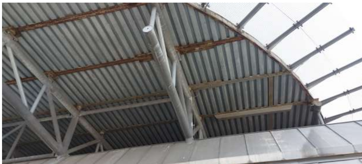
Obr. 28: Spodní zkorodované příruby zabetonovaných nosníků UPE 160 včetně obvodového UPE 200. Vazníky jsou poměrně chráněné před korozí, ale již vyžadují ochrannou údržbu nátěrem
