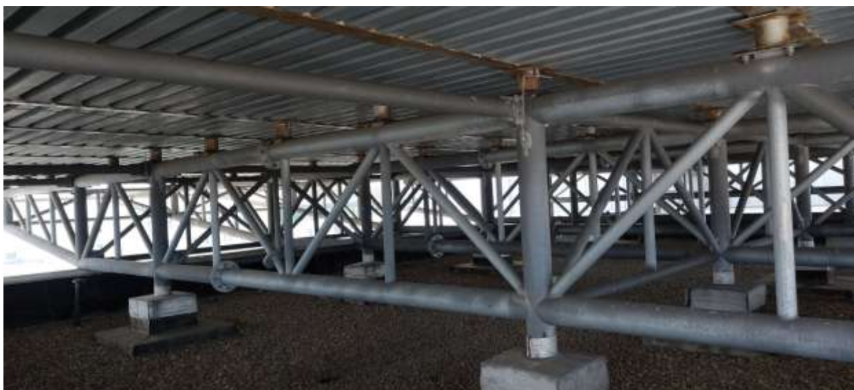
Obr. 8: Ocelová konstrukce vazníky s příčným stabilizačním zavětrováním. Dolní příruby zabetonovaných nosníků UPE 160 jsou velmi zkorodované a nesplňují podmínky ochrany ocelových prvků ve venkovním prostředí C3. Na spodní přírubu jsou osazeny pozinkované plechy TR 50/200/0,80 (VSZ 11001)
