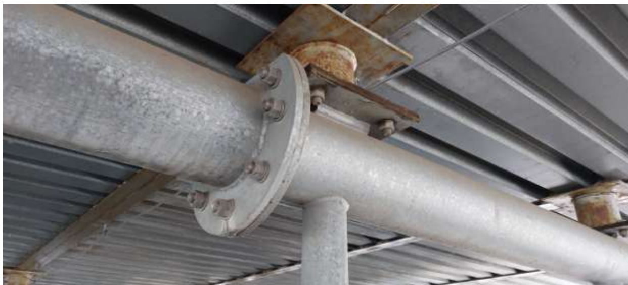
Obr. 11: Detail přírubového šroubovaného styku 7 x M 20 (8.8) u horní pásnice 194x8 příhradového vazníku. Horní osazení zabetonovaných nosníků UPE 160 v desce přes Tr 152x8 a šroubů 4 M 20 (8.8). Prvky nad horní pásnici jsou zkorodovány
