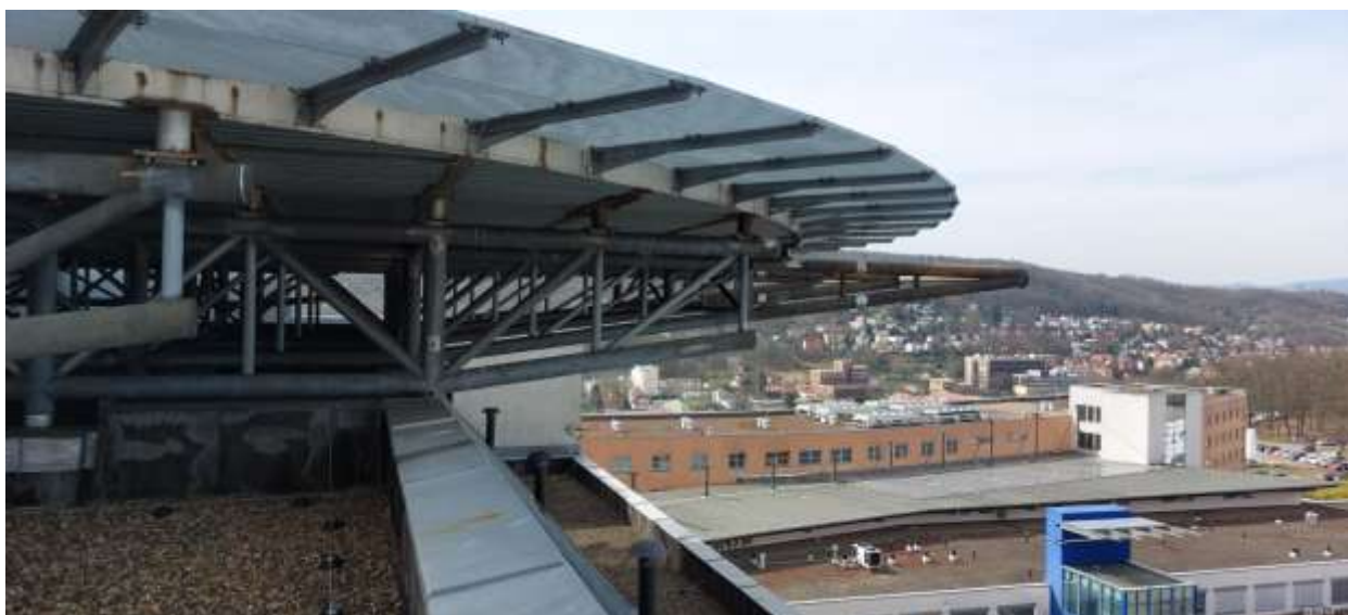
Obr. 6: Ocelová konstrukce vazníku s vyčnívajícím krakorcem. Část konstrukce mimo železobetonovou desku je zkorodovaný a nyní již není dostatečně chráněný proti korozi v prostředí C3.
