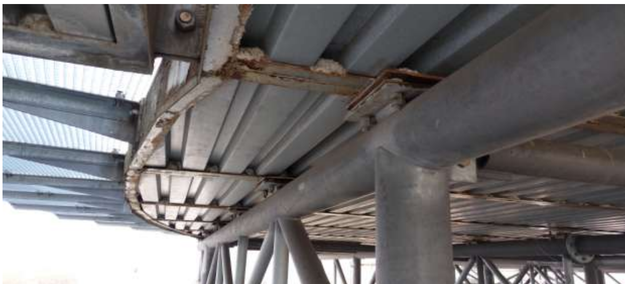
Obr. 26: Obvodový nosník UPE200 s příčnými UPE 160 a napojením na ochranný ohoz z pororoštů. Prvky jsou velmi zkorodované
