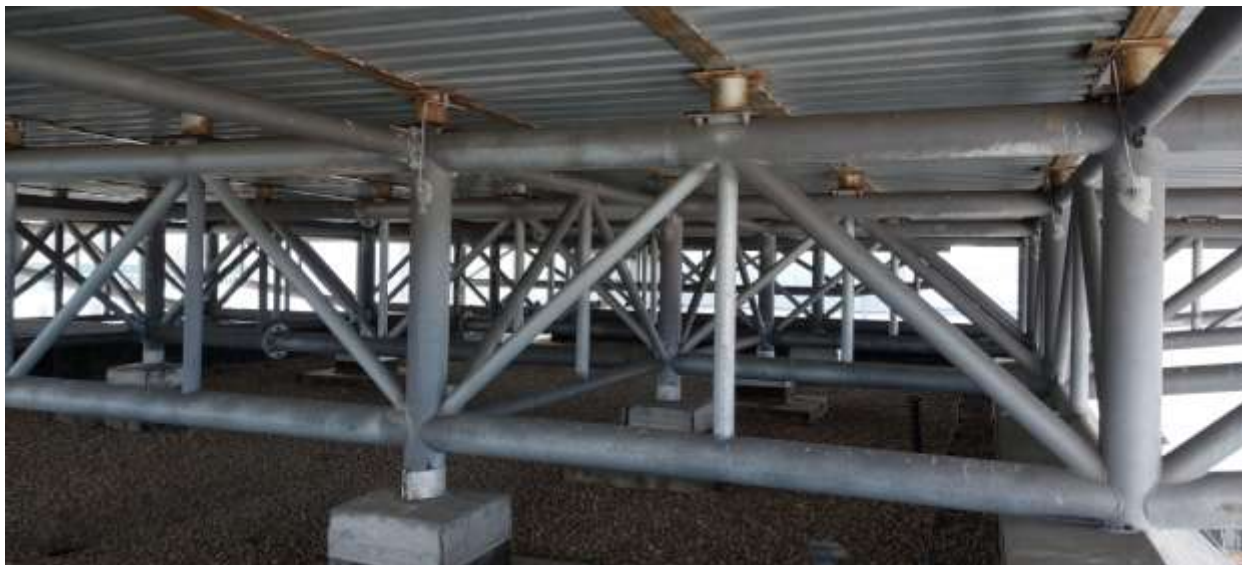
Obr. 7: Ocelová konstrukce vazníky s příčným stabilizačním zavětrováním. Dolní příruby zabetonovaných nosníků UPE 160 jsou velmi zkorodované a nesplňují podmínky ochrany ocelových prvků ve venkovním prostředí C3. Na spodní přírubu jsou osazeny pozinkované plechy TR 50/200/0,80 (VSZ 11001)
