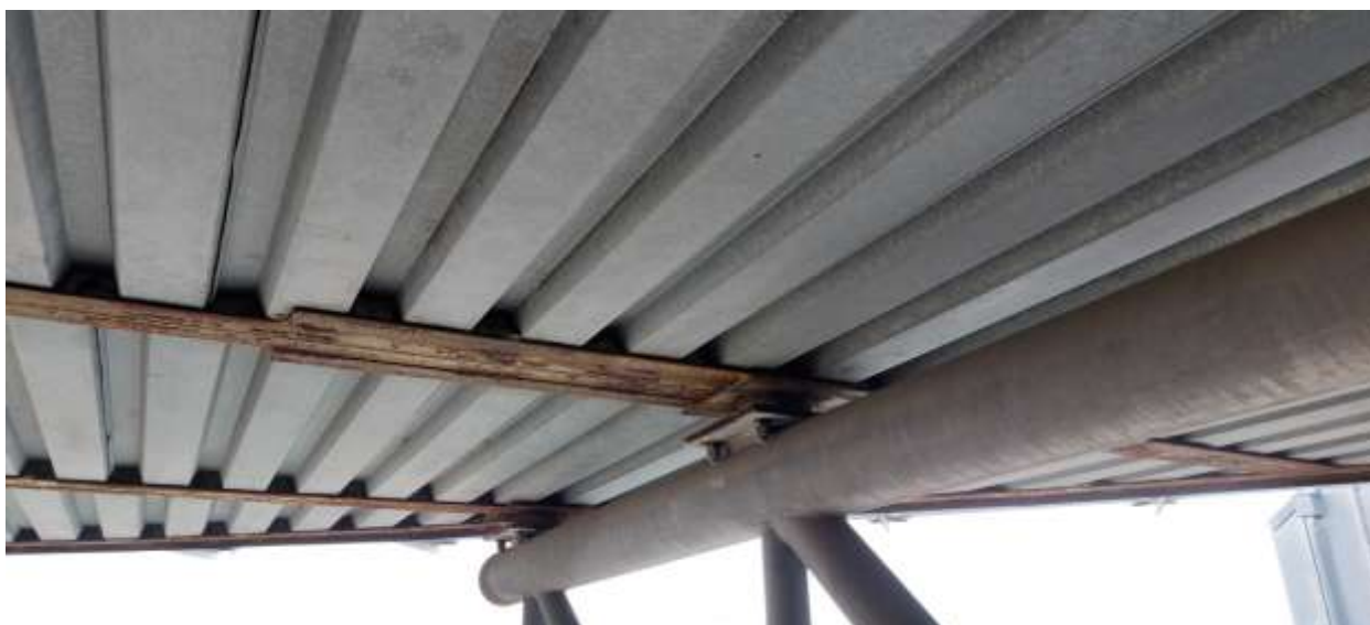
Obr. 20: Zabetonované 2xUPE (CSN) 160 s dalším zesílením 2xUPE160 spodní příruba je značně zkorodovaná
