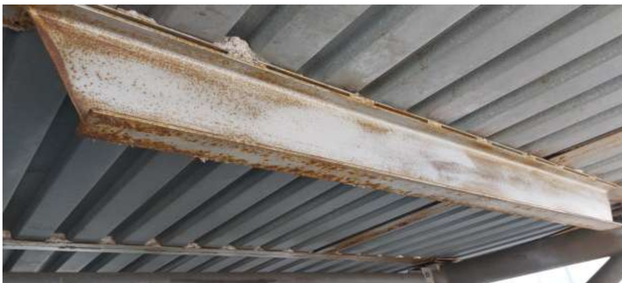
Obr. 23: Zesílení pomocí IPE 160 pod spodní přírubou. Vše je značně zkorodované.
