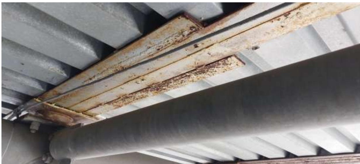
Obr. 21: Zabetonované 2xUPE (CSN) 160 s dalším zesílením 2xUPE160 spodní příruba je značně zkorodovaná
