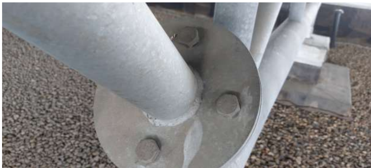
Obr. 13: Detail přírubového šroubovaného styku 4 x M 20 (8.8) u diagonály 89x7 příhradového vazníku. Bez staticky významné koroze, Změřená tloušťka v daném místě byla 400 \mu m.
