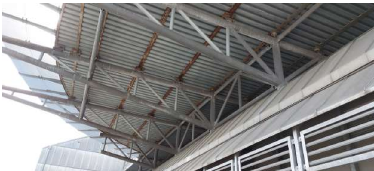
Obr. 27: Spodní zkorodované příruby zabetonovaných nosníků UPE 160 včetně obvodového UPE(CSN) 200. Vazníky jsou poměrně chráněné před korozí, ale již vyžadují ochrannou údržbu nátěrem
