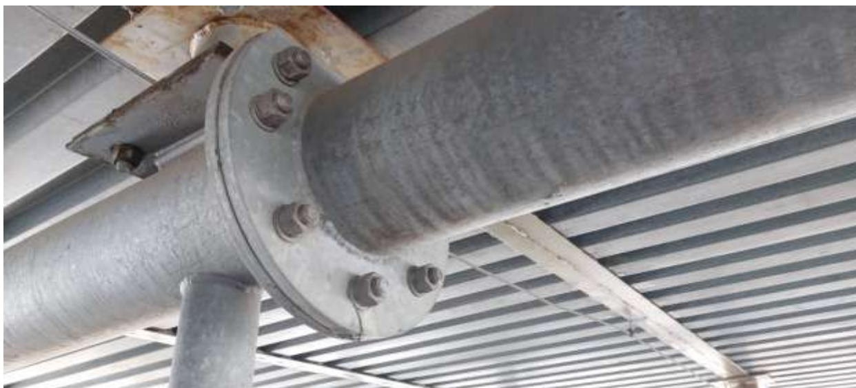
Obr. 12: Detail přírubového šroubovaného styku 7 x M 20 (8.8) u horní pásnice 194x8 příhradového vazníku. Horní osazení zabetonovaných nosníků UPE 160 v desce přes Tr 152x8 a šroubů 4 M 20 (8.8). Prvky nad horní pásnici jsou zkorodovány
