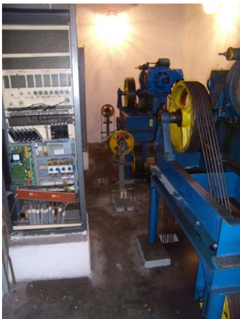
Společná strojovna pro dva výtahy
