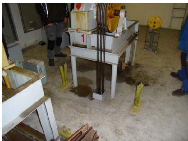
Strojovna výtahu TLV 500
