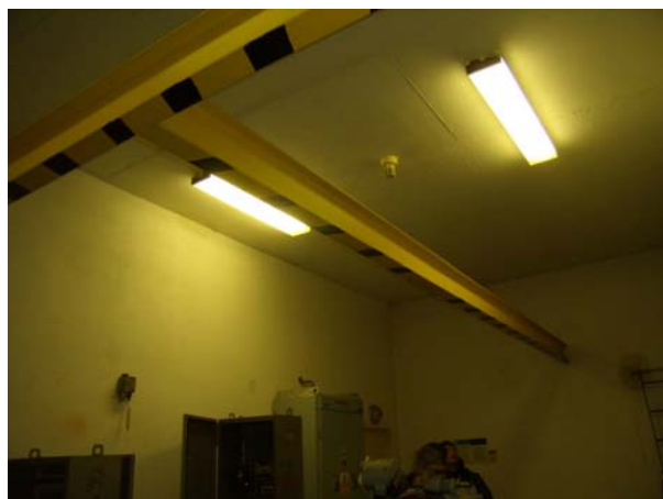
montážní nosník ve strojovně
