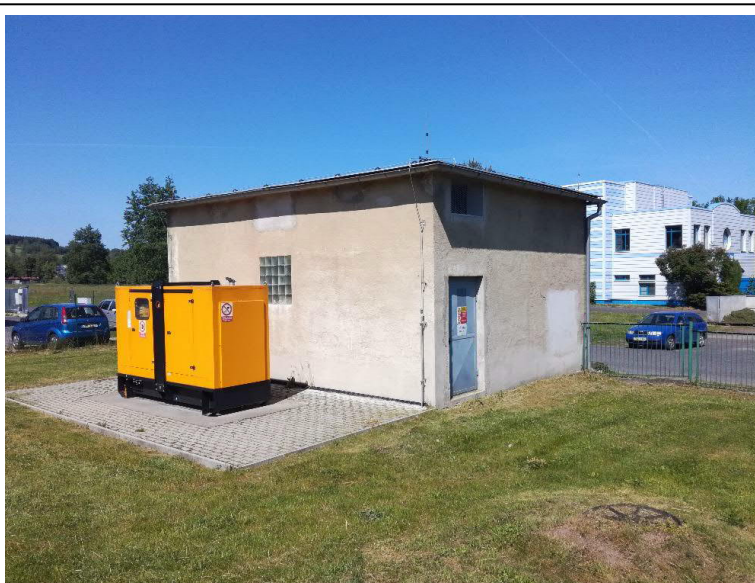
Trafostanice a náhradní zdroj
