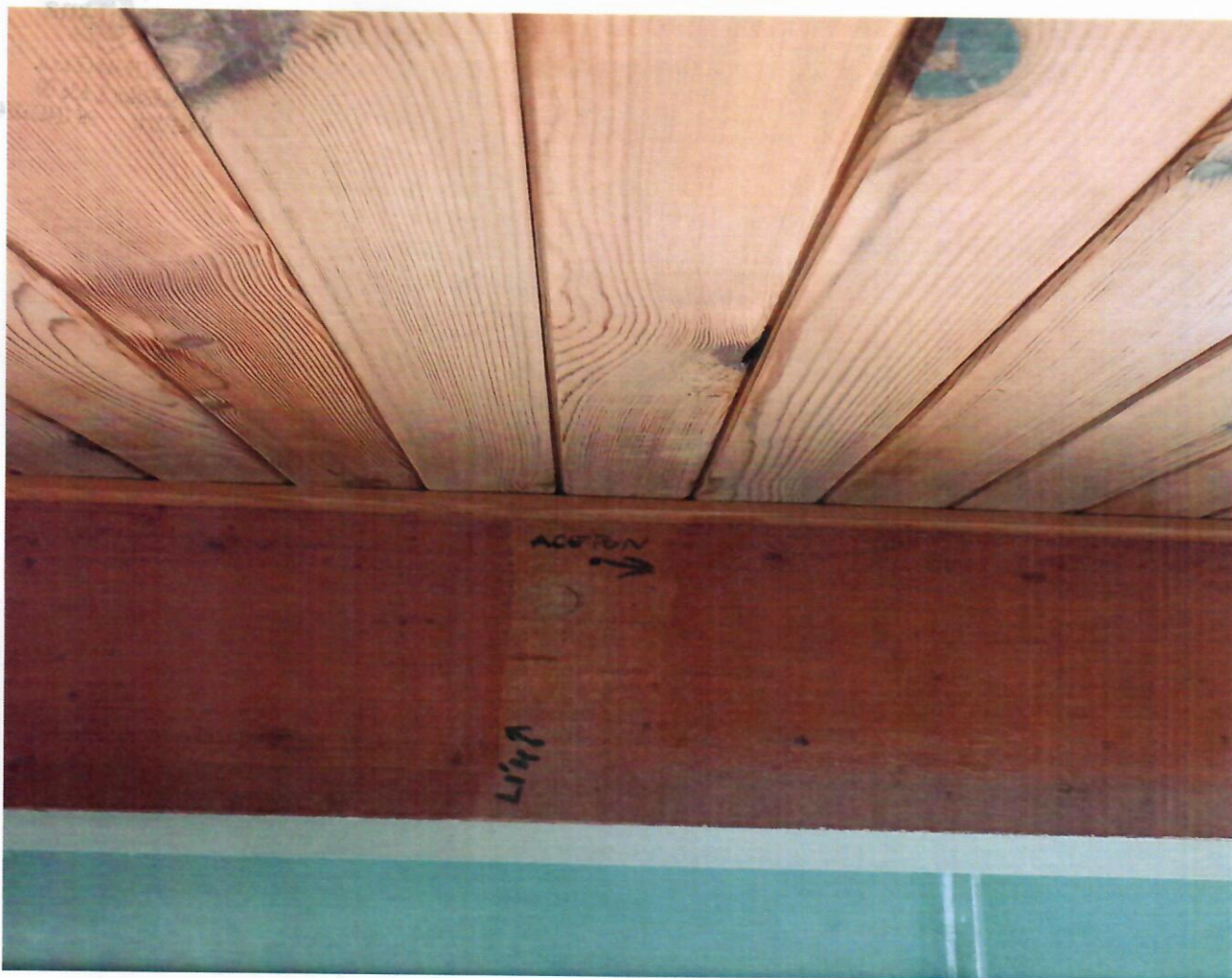
Celkový pohled na ošetřené místo
