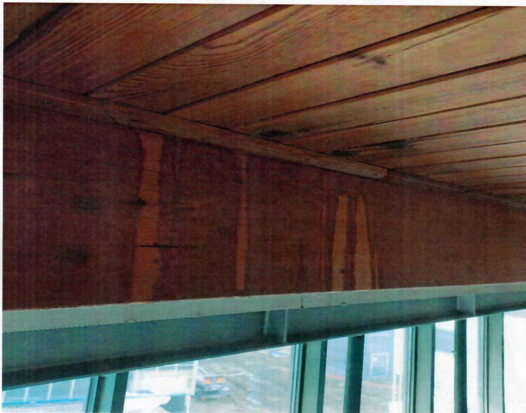
Pohled na místo aplikační zkoušky PPN na dřevě, zde je patrné zatékání vody
